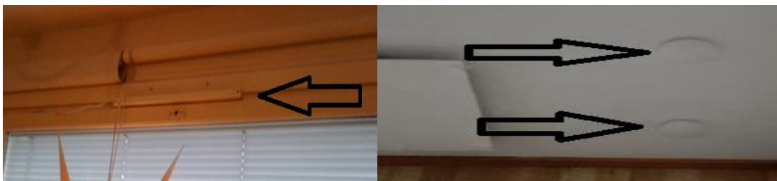
Kuva 4, korvausilmaventtiili ja ulkoseinässä olevat reiät.
