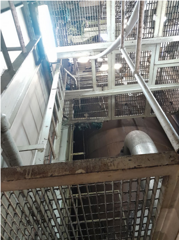
Kuva 1. Rikkipesurijärjestelmä aluksessa. Kuva: Elias Altarriba
