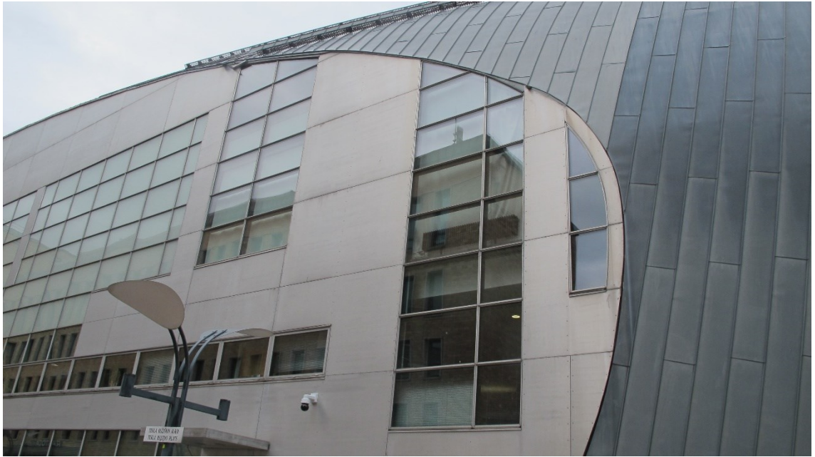
Kuva 8. Itäjulkisivun kaareva räystääslinja ennen korjausta. (Ruutiainen 2020).
