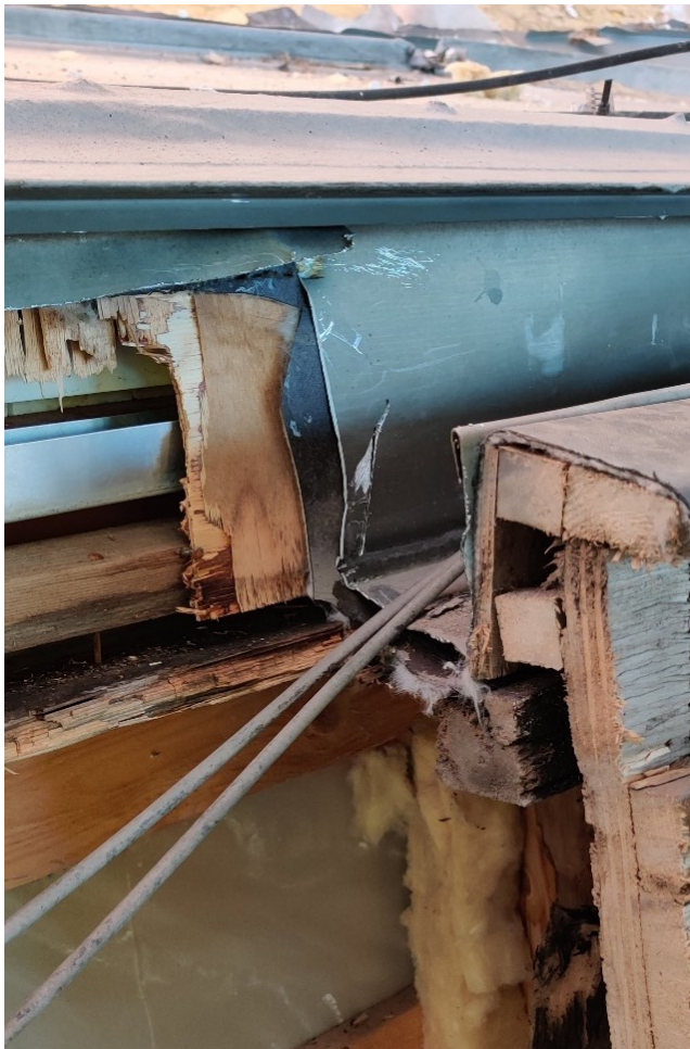
Kuva 21. Valokuva kohdekäynniltä 5.3.2021. Rusetti-ikkunan reunakouru.
