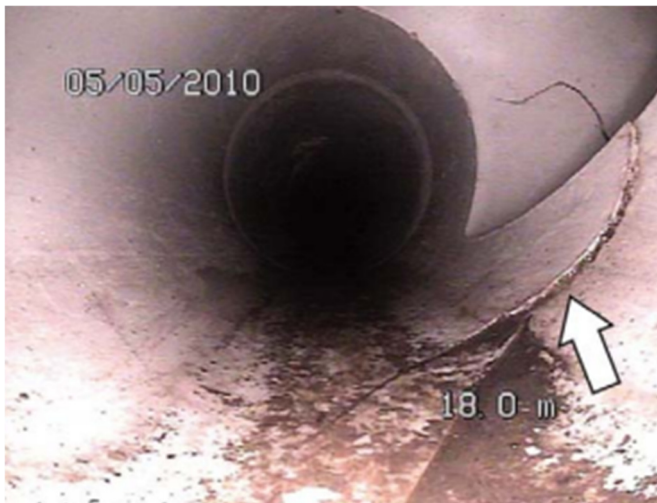
KUVA 22. Viemäriputken T-haara haljennut (6, s. 78)
