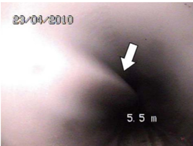
KUVA 24. Muodonmuutos viemäriputkessa (6, s. 78)
