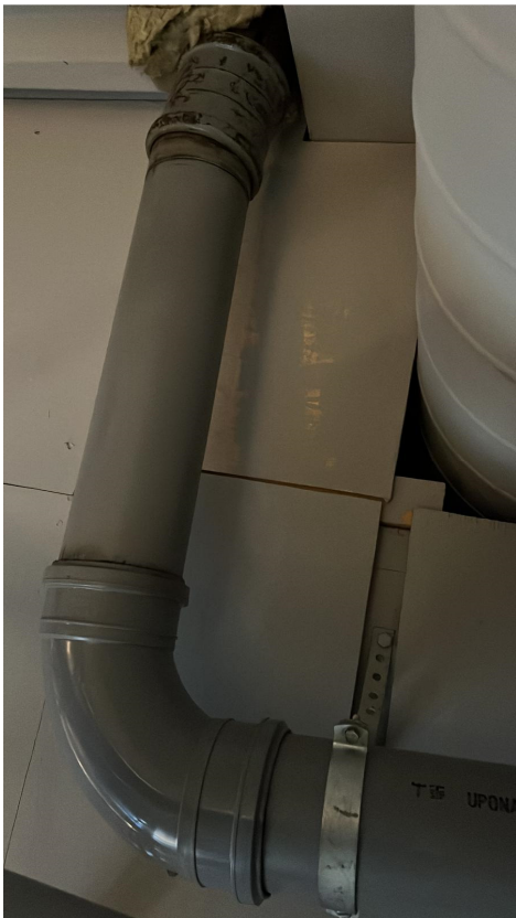
KUVA 20. Viemärin puutteellinen kannakointi aiheuttanut liitoksen osittaisen irtaamisen
