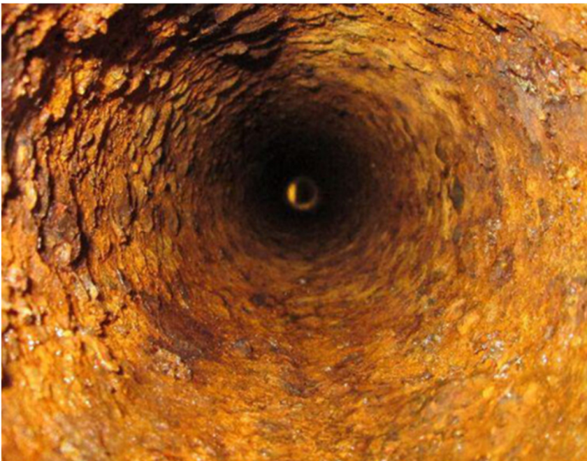
KUVA 25. Valurautaputken sisäpuoli syöpyneyt epoksinnoitteen laatuongelmien vuoksi (23)
