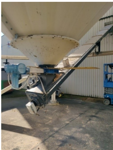
Kuva 13. Varastosiilon ja kuljettimen välisen mekaaninen säätöpelti ja levyluistiventtiili.
