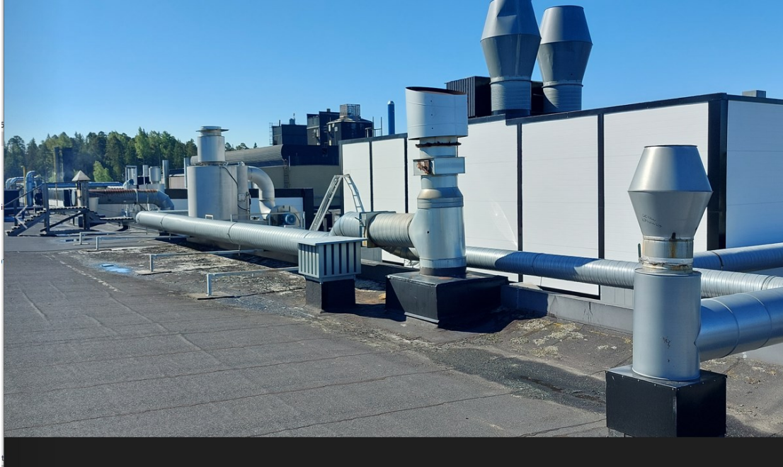
Kuva 2. 2. kuivaimen ja leijukuivaimen poistoputket
