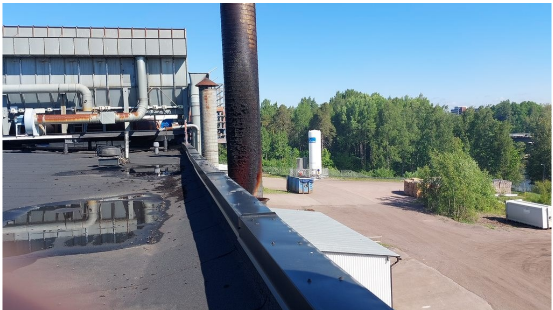
Kuva 1. 1. kuivaimen kolme poistoputkea rakennuksen itäpuolella katolta kuvattuna
