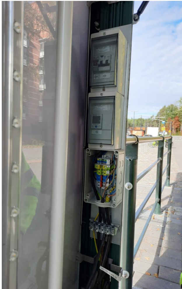
Kuva 11. Kuvassa näkyy Talin Siirtolapuutarhan pysäkin PK-13 bussikatoksen alakeskus, joka sijaitsee valaistun mainosvitriinin takana katoksen sisällä.
