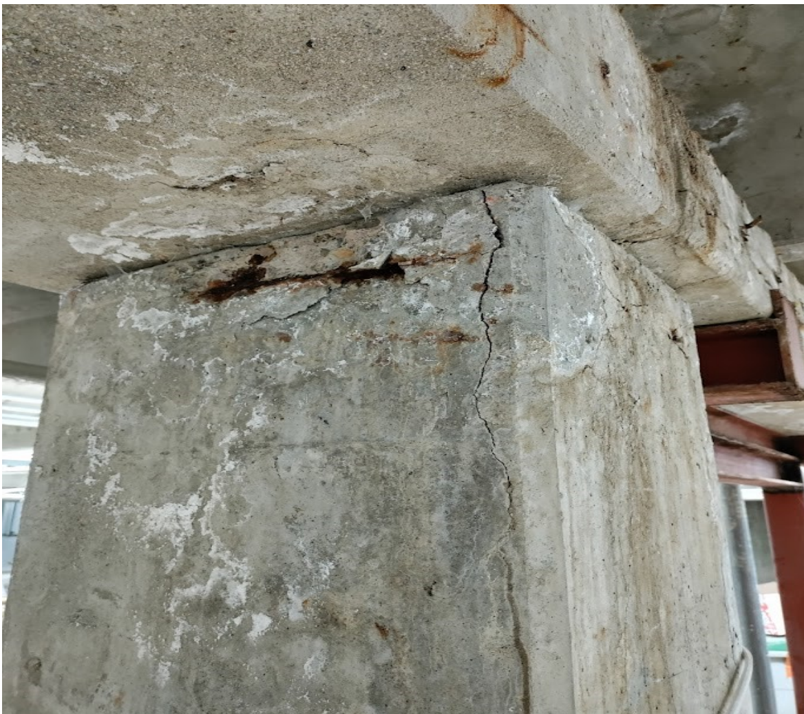
Figur 10. På bilden syns en del av de skador som uppstått på pelaren.
