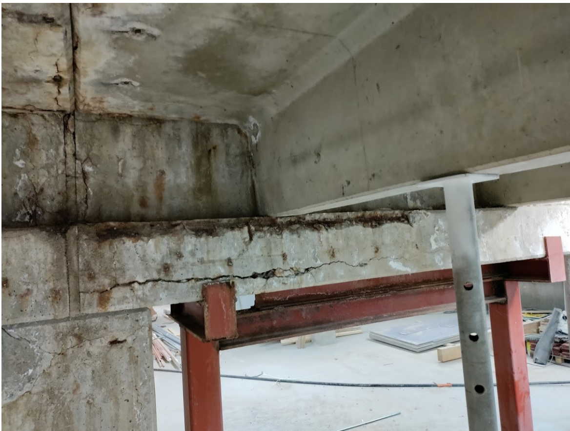
Figur 9. Bild på balkens skador.
