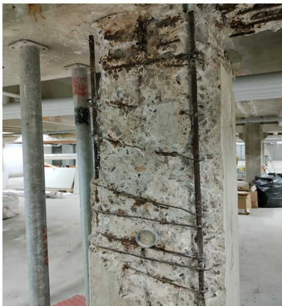
Figur 16. Korrosion på armeringen.
