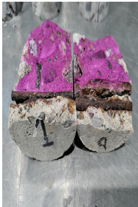
Figur 15. Man ser hur korrosion angripit stålet.
