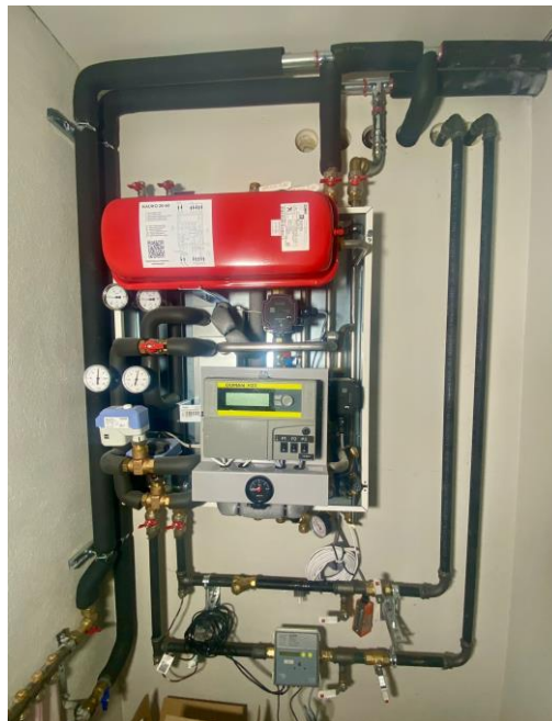
Figur 12. Fjärrvärmeundercentralen i huset.
