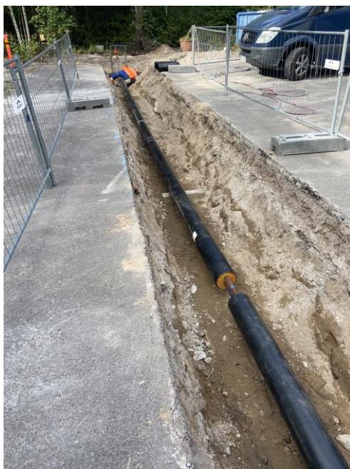
Figur 11. Fjärrvärmeanslutning till huset.
