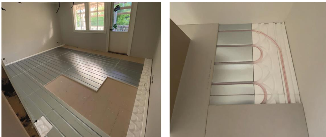
Figur 13. Roth compact installeras i övre våningen.
