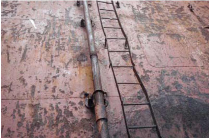
Kuva 21. Nosturin aiheuttamia vaurioita ruumassa ja pinnoitteessa (Bulk Carrier Guide 2010a)
