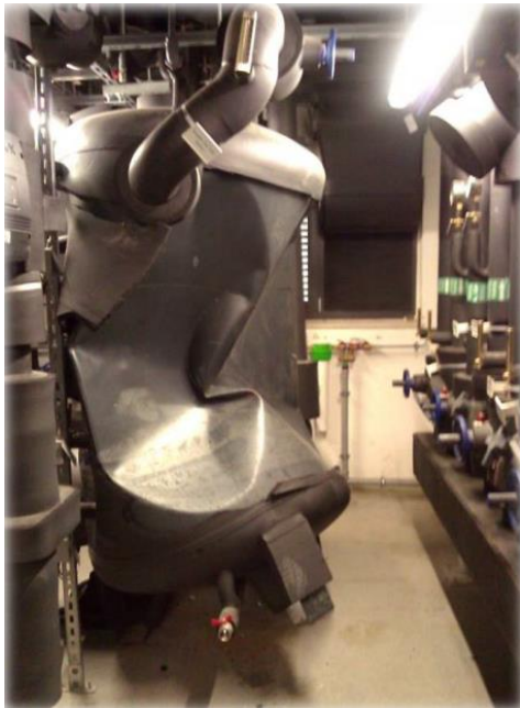
Kuva 6. Vakuumissa vaurioitunut säiliö
