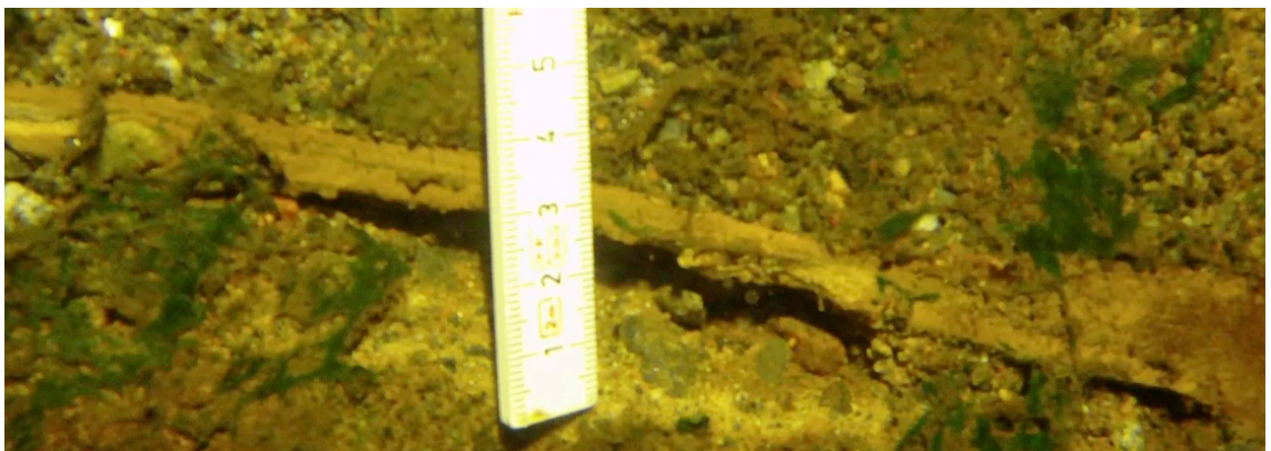
Kuva 14. Pistepilvimateriaalissa huomaamaton erottunut kerros betonivalussa, Kasinosaaren silta välituki T11
