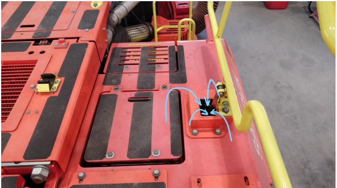
Kuva 33. Vasen hydraulioiljyjäähdytin imee ilmaa ulkopuolelta tästä.
