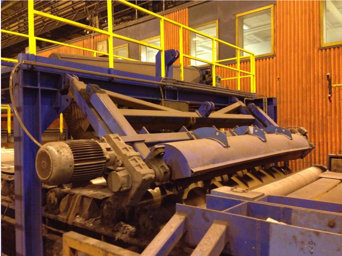
KUVA 4. Levyvalssauslinjan harjakone, joka sijaitsee sivu- ja paloittelijaleikkurin välissä
