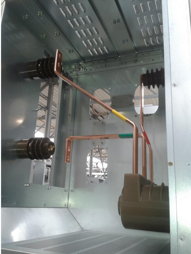
Kuva 3. Kokoojakiskojen järjestys kaapissa
