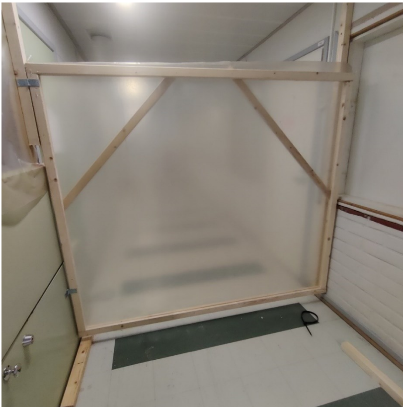
Kuva 4. Viiden metrin kääntyvä sivuseinä. Avoin yläosa päästää keinosavun leviämään
