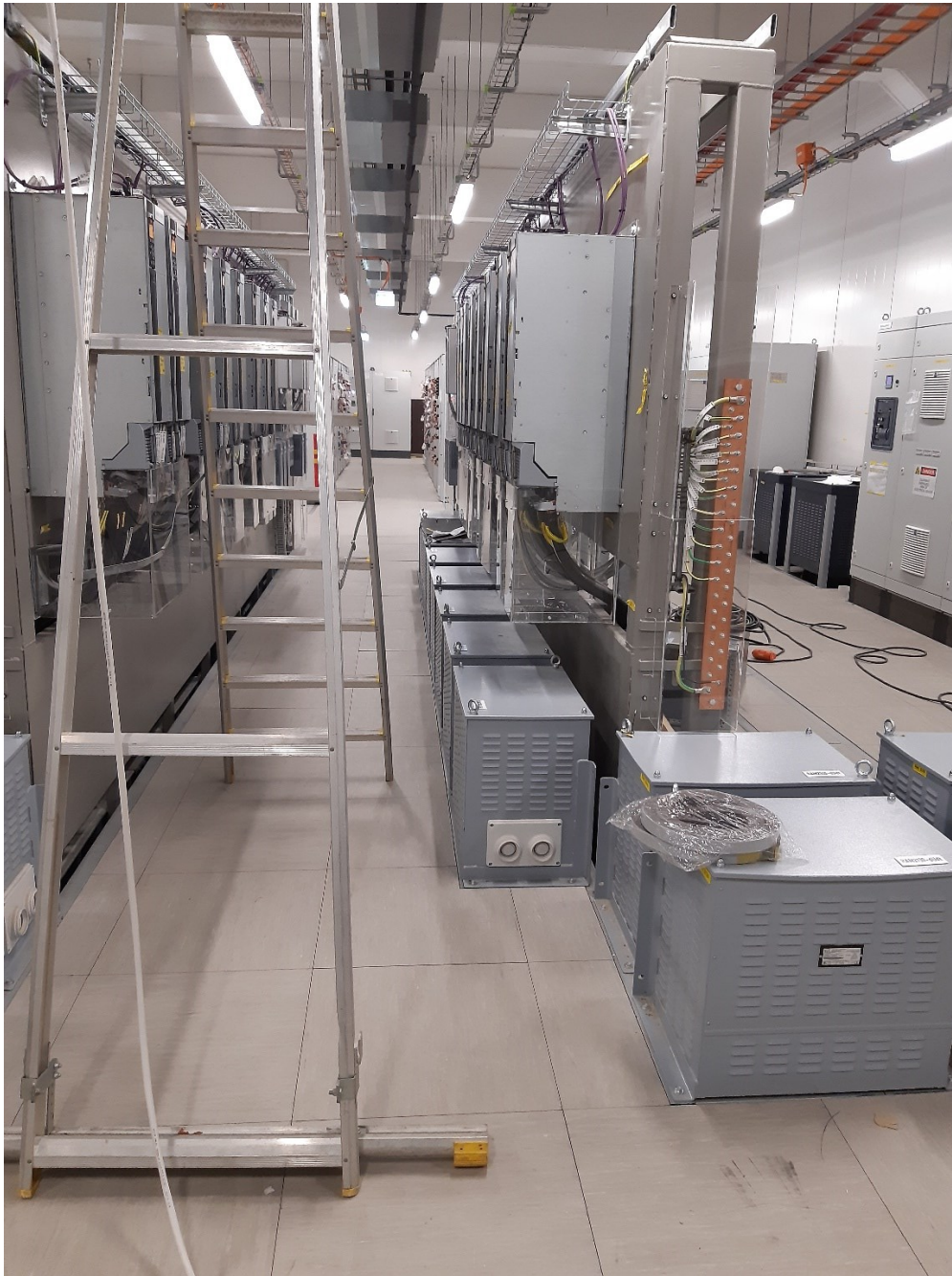
Lattialle sijoitetut suotimet, asennus johtui sähkötilojen asennusvaatimuksista (käytävän minimileveys 800 mm), kuvassa myös seinäasennetut taajuusmuuttajat.
