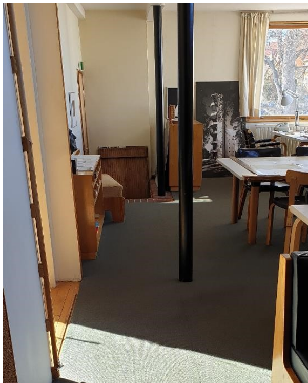
Kuva 41 Korjattava alue länsiseinällä lipaston ja ikkunan välissä (Kajaluoto 2022)
