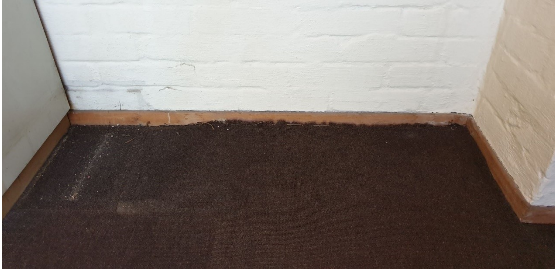
Kuva 25 Korjattava alue (Kajaluoto 2022)
