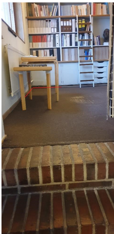
Kuva 33 Korjauskohta merkittynä punaisella viivalla (Kajaluoto 2022)
