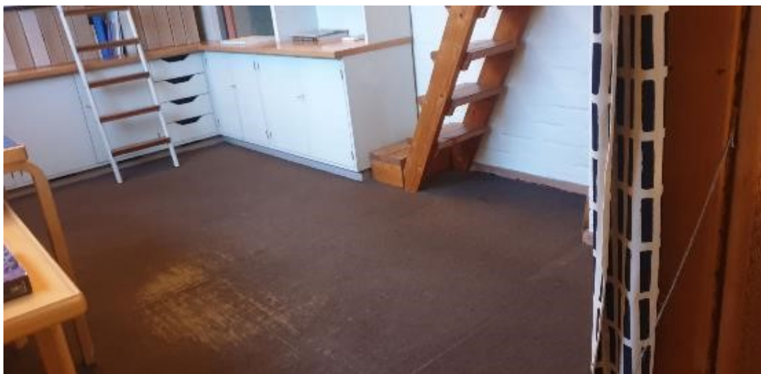
Kuva 24 Kuvassa oikealla ylhäällä puinen portaikko ja sen alla korjauskohta (Kajaluoto 2022)
