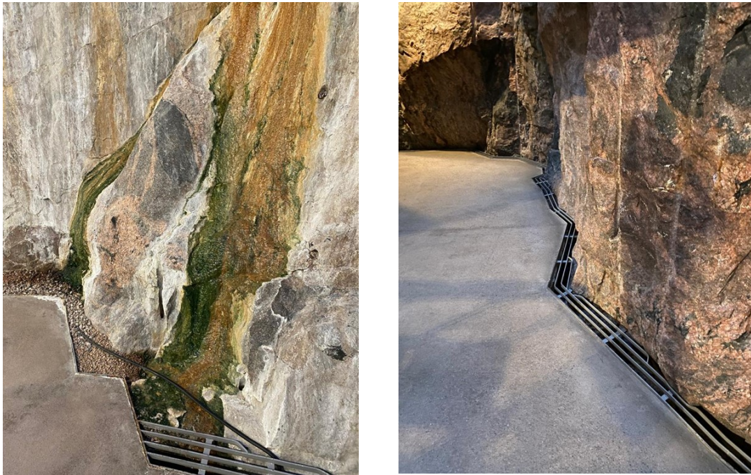
9. ja 10. Valtaosa kirkkosalin seinämistä on jätetty kalliopinnalle ja kallion halkeamista tihevä vesi valuu niitä pitkin hallitusti alas lattianrajan vedenpoistojärjestelmään. Kuvat: © tekijän
