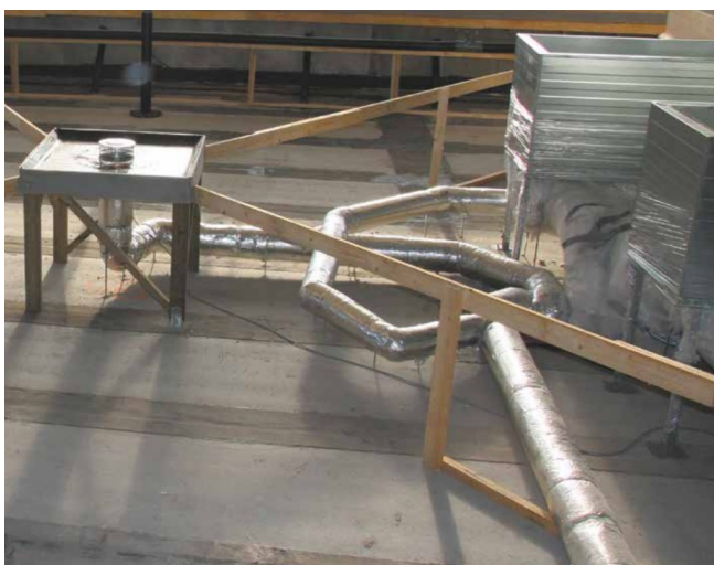
Kuva 5. Yläpohjaan asennettua talotekniikkaa ennen lämpöä eristävän kevytsoran levittämistä (8).
