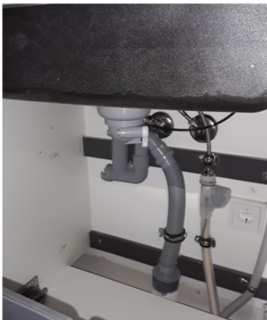
Kuva 11. Keittiön astianpesualtaan putkistojen kannatus.
