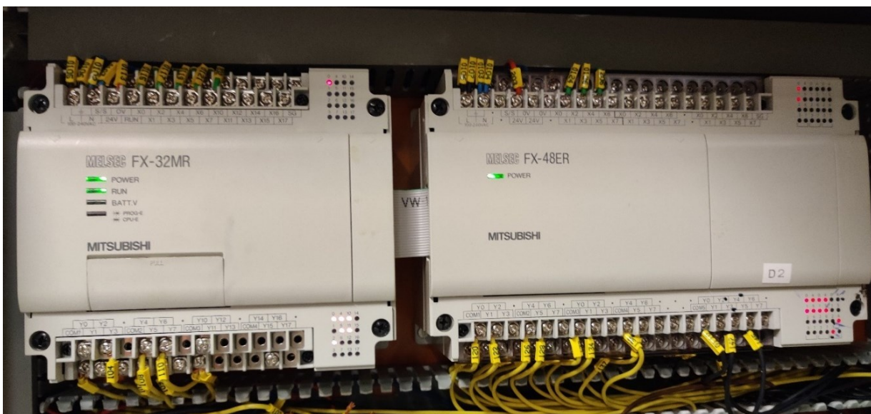
Kuva 4. Mitsubishi FX-32MR-ES logiikka ja FX-48ER laajennusmoduuli
