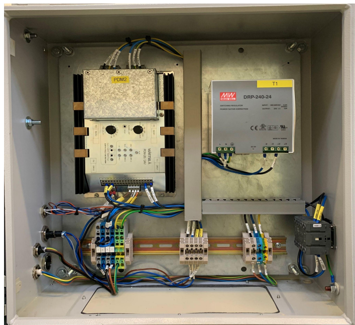
Figur 21. Det nya matningsskåpet med 10 amperes transformator.
