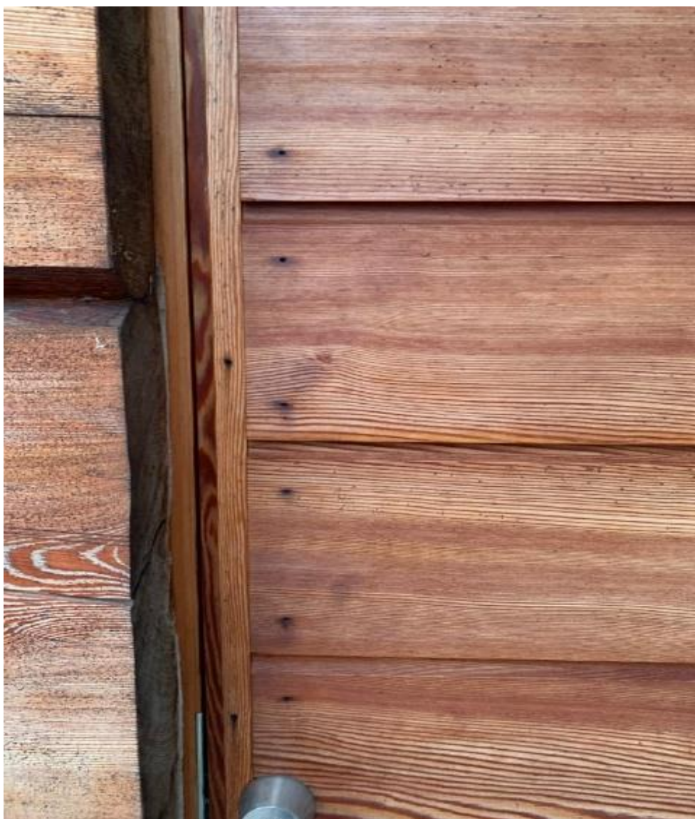
Kuva 9. Ulko-oven ulkoverhouksen korroosio jäljet
