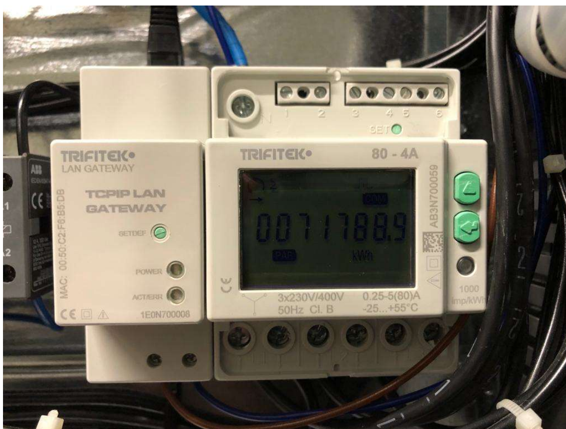
Kuva 10. Energiamittari asennettuna ilmanvaihtokoneen ohjauskeskukseen.
