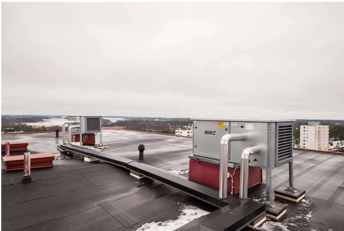
Kuva 9. Kuvassa HiLTO-yksiköitä keräämässä hukkalämpöä talteen (Tom Allen Senera Oy).
