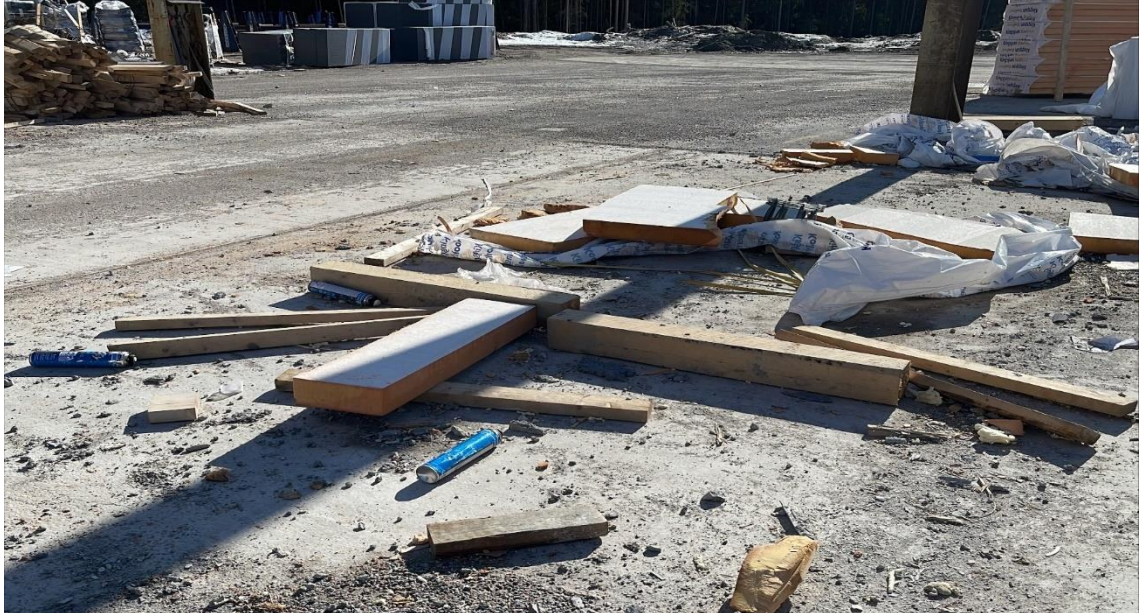
Kuva 5. Ontelolaattojen eristys paikalla paljon puu-, muovi- ja uretaanijätettä sekä tyhjiä polyuretaanipulloja.
