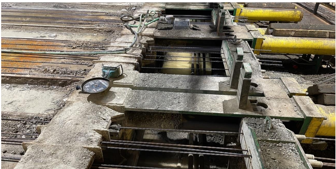
Kuva 12. Jokaisen tuotantolinjan päässä on suojaamaton aukko hydraulikkakoneiston välissä.
