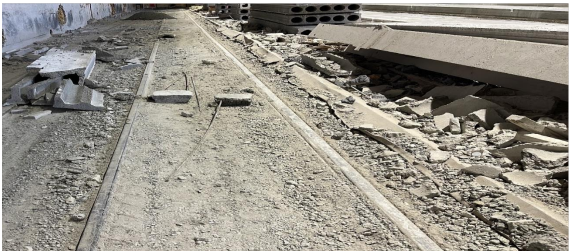
Kuva 6. Käytävällä oli runsaasti betonijätettä.
