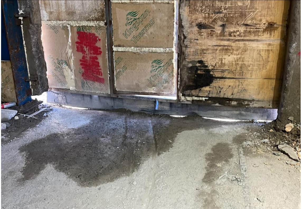
Kuva 3. Tuotantotilan etuovi huonossa kunnossa.
