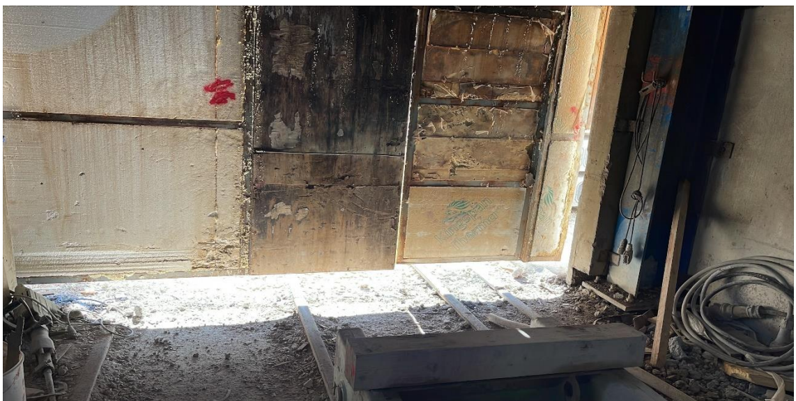
Kuva 2. Tuotantotilan takaovi huonossa kunnossa.
