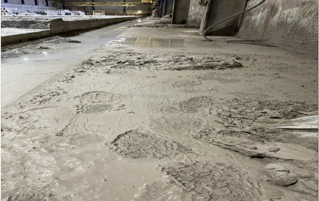
Kuva 7. Ontelolaattojen sahausjätettä käytävällä.
