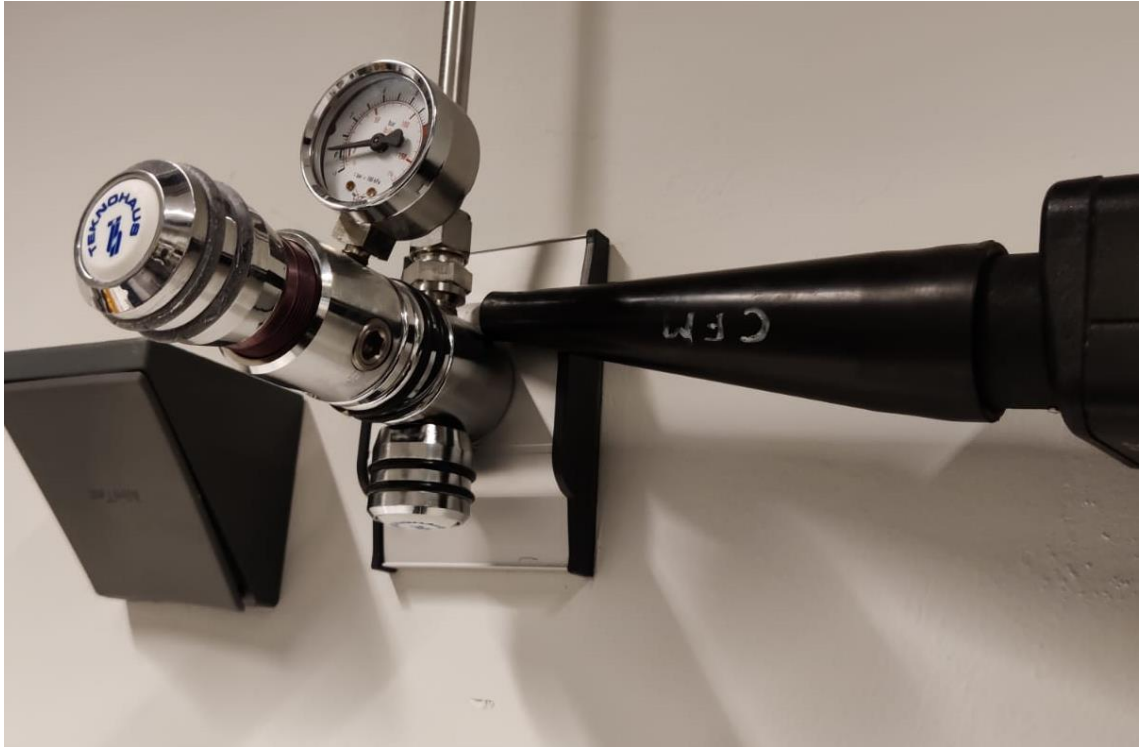
Kuva 25 Vuoto kierreltiimessä seinän puolella
