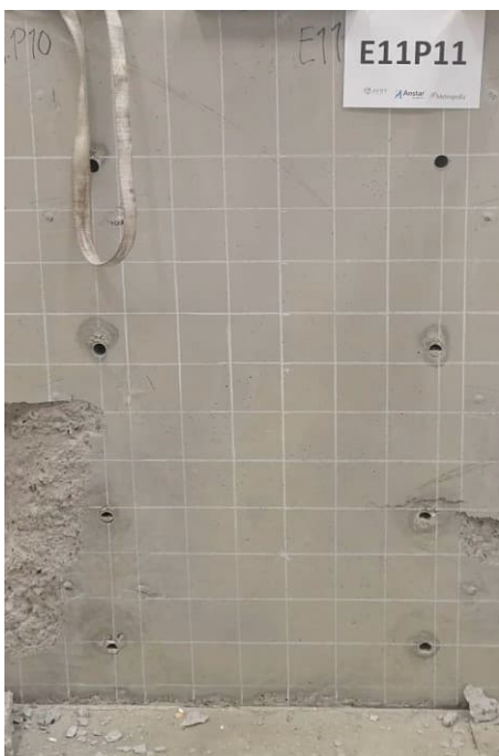
Kuva 36 Aloitustilanne. E11P10 vasemmalla sekä E11P12 oikealla tehtyjen kokeiden halkeamat saattaneet vaikuttaa P11 halkeaman syntyyn.
