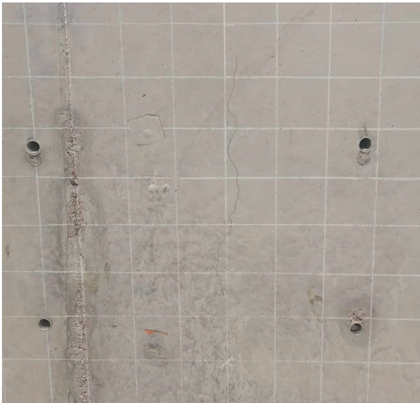
Kuva 31 P6. Halkeamaa vahvistettu lyijykynällä. Raksi merkkää tyssän korkeutta ja kohtaa.
