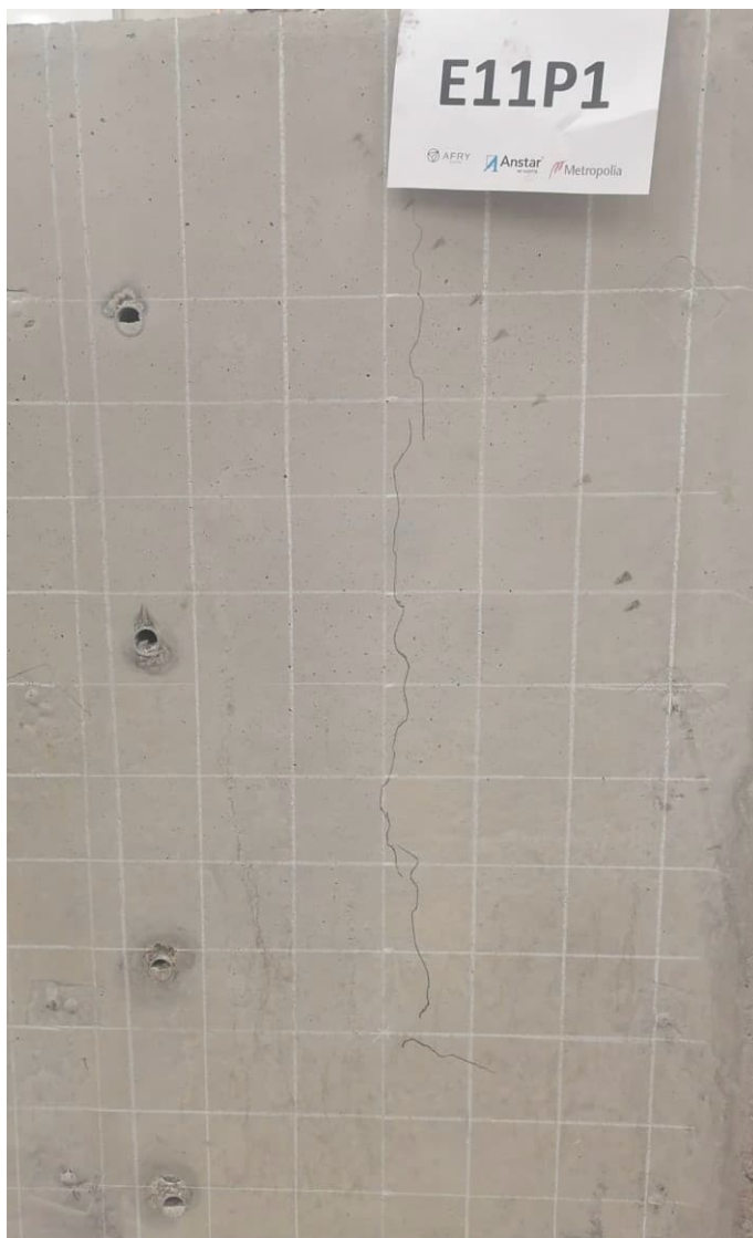
Kuva 21. E11P1 halkeama betonipinnassa.
