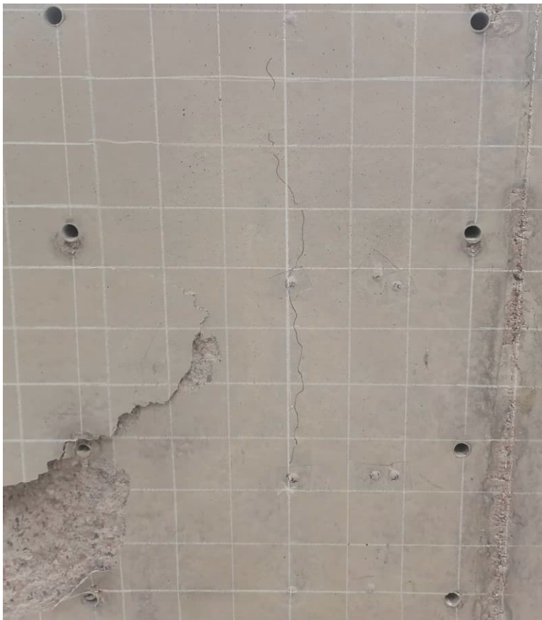
Kuva 30 P5. halkeamaa vahvistettu lyijykynällä. Raksi merkkää tyssän korkeutta ja kohtaa.
