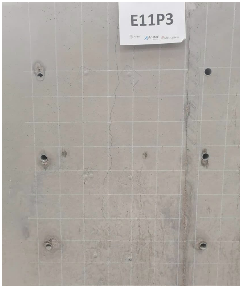
Kuva 28. E11P3 betonipinnassa pultin kuormituksesta johtuva halkeama.
