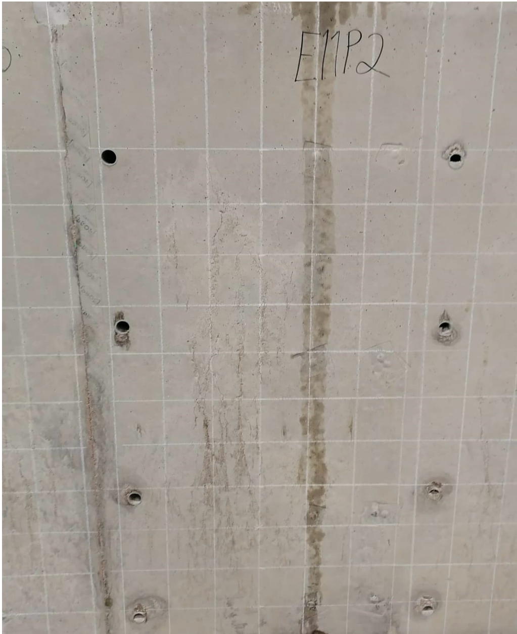
Kuva 27. E11P2 betonipinta kuormituksen jälkeen.
