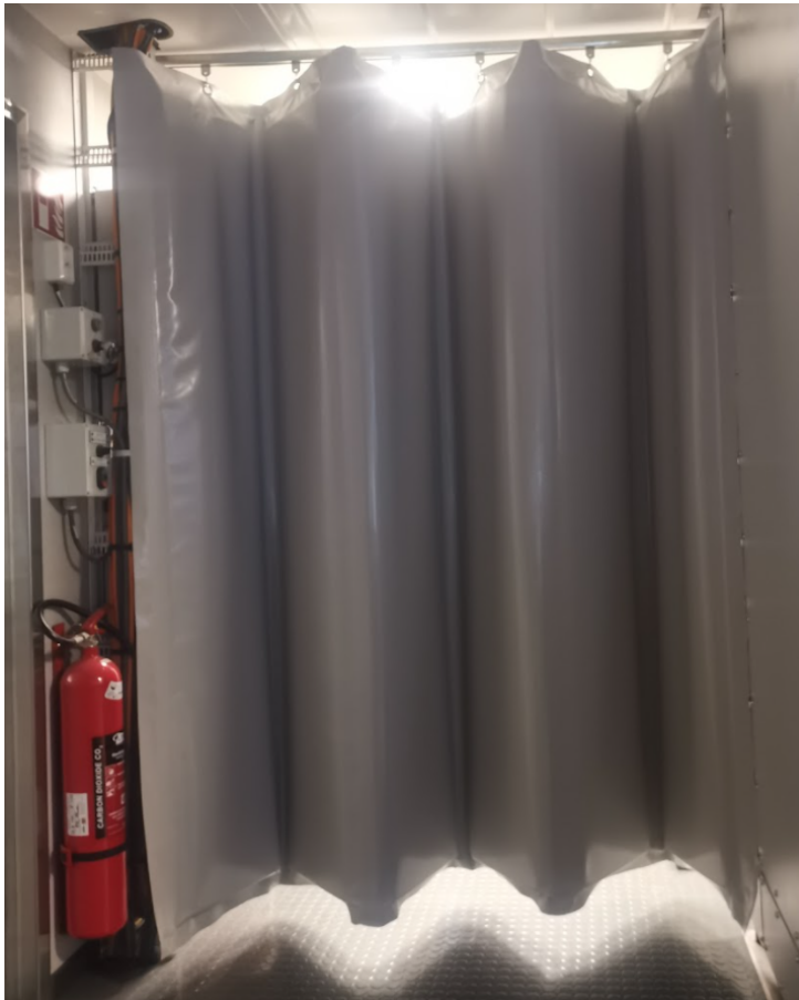
Fig.3 Isolerad gardin på styrbord sida om förliga eltavlan.
