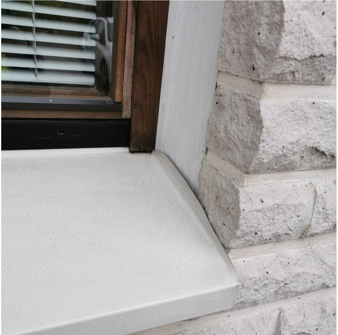
Kuva 6. Ikkunan vesipelti saumauksen puutuminen ( https://www.kajonsteel.fi/peltiostat/ikkunapelti/ .)
