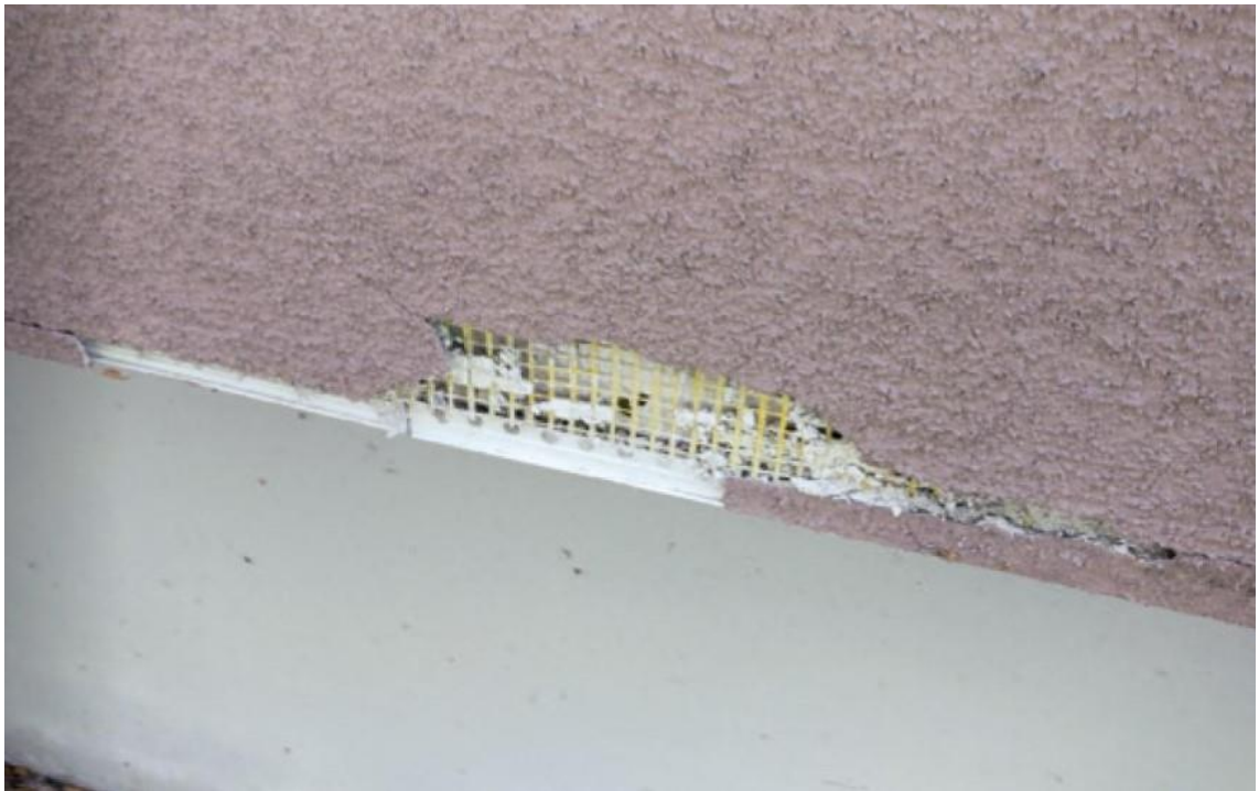
Kuva 7. Halkeama ja verkotuslaastin pakkasrapautuma sokkeli liittymässä. ( Betoni.com/referenssi/eristerapattujen-julkisivujen-korjaaminen/. )
