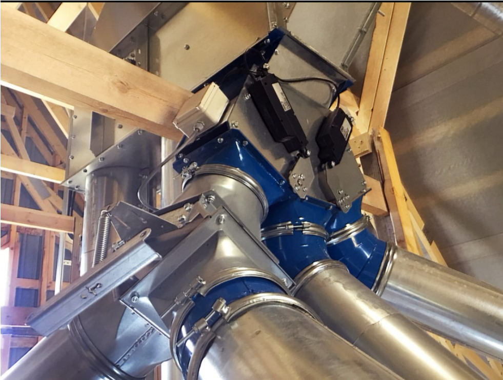
Kuva 4. Elevaattorin sähkötoiminen jakaja, (Araska-metalli, i.a.-b).
