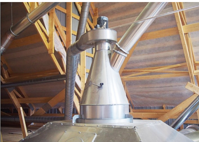
Kuva 5. Kuivurin esipuhdistin, (Araska-metalli, i.a.-c.)
