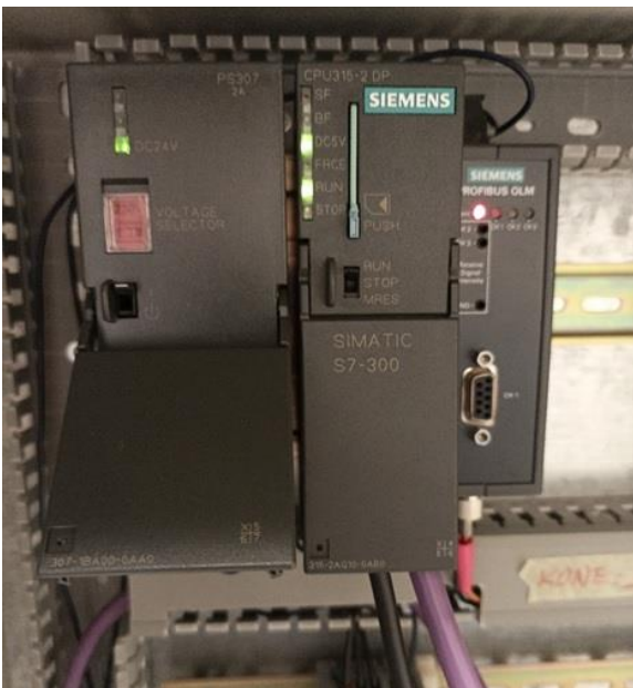
Kuva 5. Oikeanpuoleinen sähkökaappi, virtalähde, CPU ja OLM.
