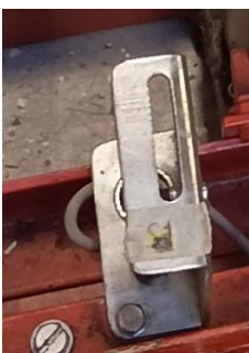
Kuva 10. Hissin heijastinanturin alkuperäinen kiinnitys
