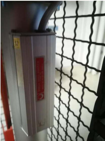
Kuva 7. Hissin yläpään magneettinen lähestymiskytkin
