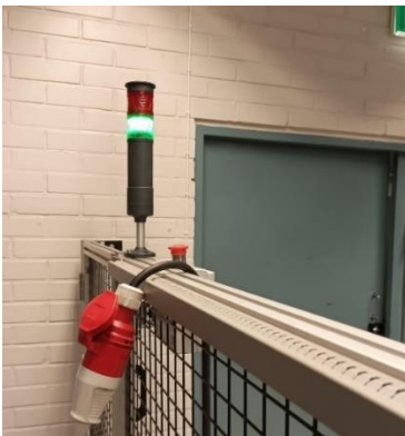
Kuva 11. Toinen valotorni sisäänkäyntiportilla
