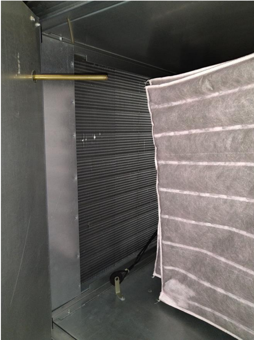
KUVA 7. IV-koneen pattereiden lamellit tarkastetaan ja tarvittaessa puhdistetaan.
