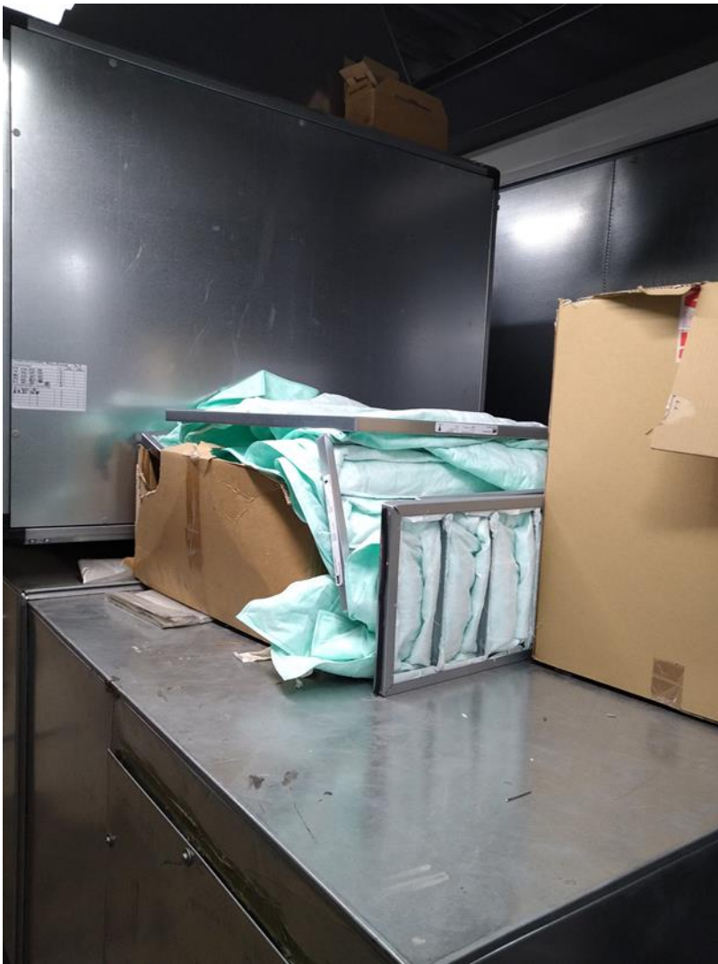
KUVA 4. Huolloissa tulee varmistua, ettei ylimääräistä tavaraa ole IV-konehuoneessa.
