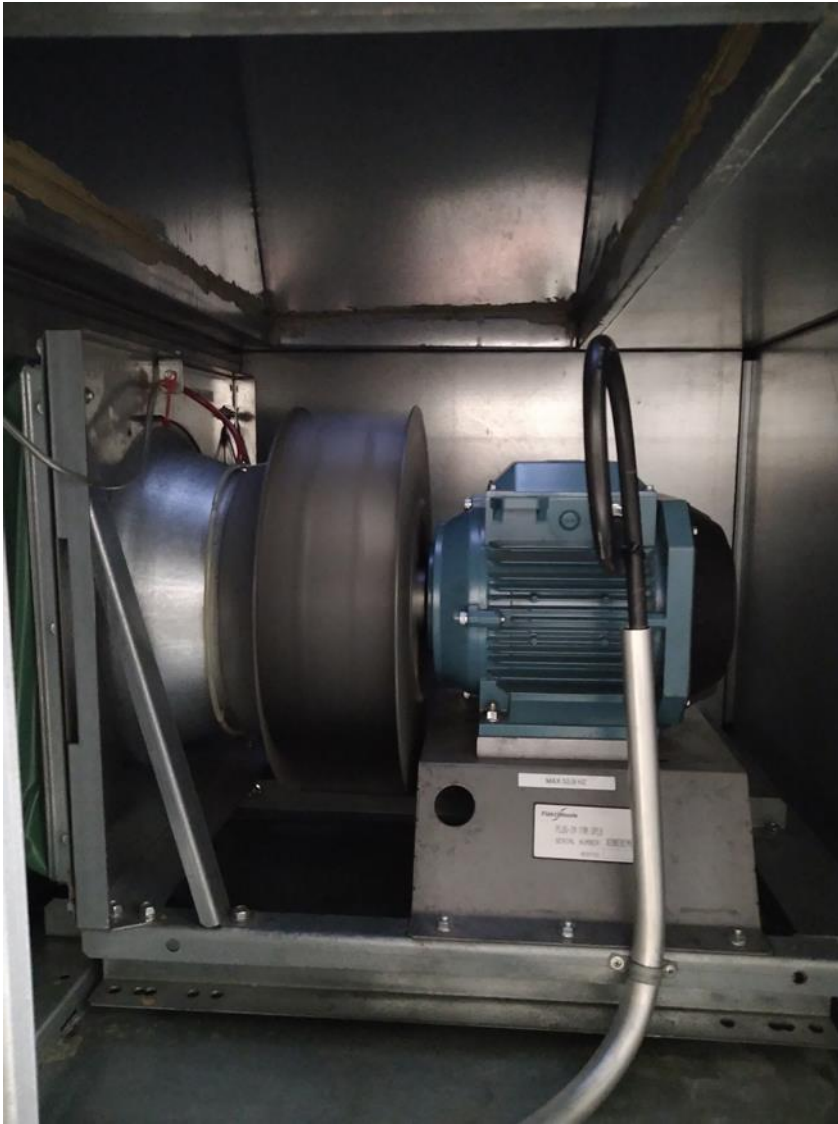
KUVA 6. Puhaltimen toiminta sekä laakerit tulee tarkastaa.
