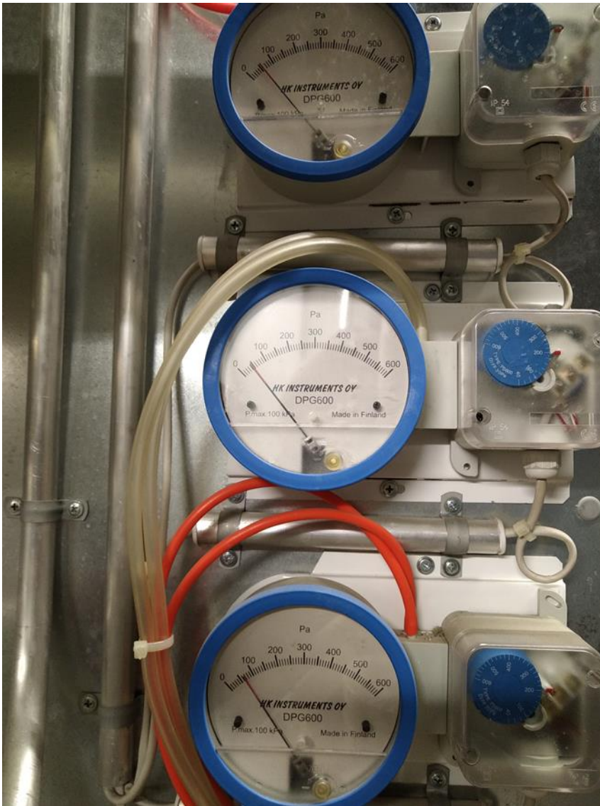
KUVA 5. Suodattimien paine-ero otetaan ylös ennen suodattimien vaihtoa, tarvittaessa mittarit kalibroidaan.
