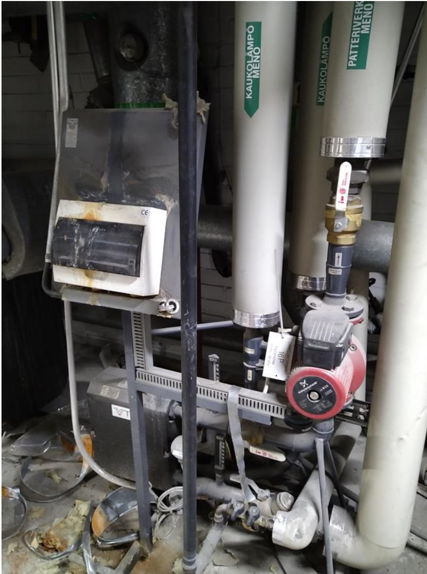
KUVA 14. Kiertovesipumppujen toiminta tarkastetaan ja mm. se, että putkistojen virtausnuolet on asennettu ja ne pitävät paikkaansa.
