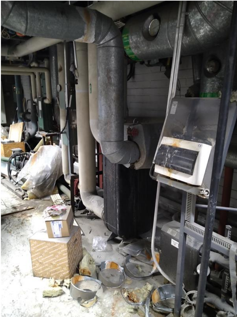
KUVA 12. Lämmönjakokeskuksessa ei saa olla sinne kuulumatonta tavaraa.
