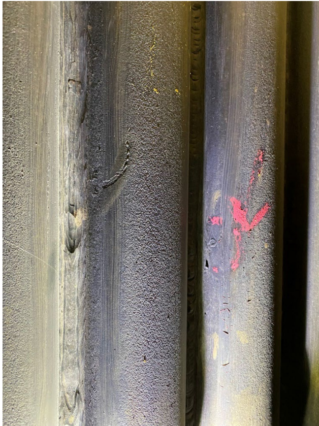
Kuva 26. Käytössä syntynyt, sytytysjälkeen keskittyneestä korroosiosta seinäputkessa.
