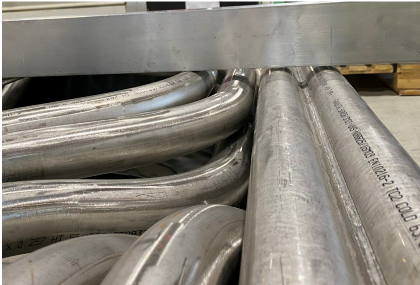
Kuva 29. Putkien tason eron mittaus oikolaudan avulla. Putket voidaan mitata järjestelyllä ja seurata käytön aikana tapahtuuko putkien linjauksessa muutoksia.
