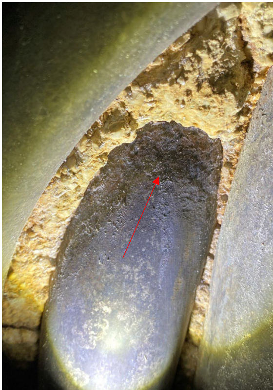
Kuva 14. Ilma-aukkojen massauksen alle kääntyvien putkien korroosiota
