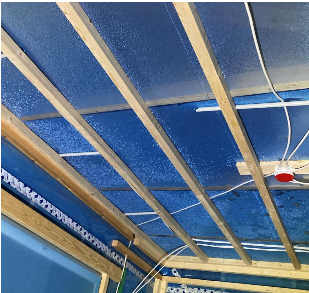
Kuva 6. Veden kondensoituminen höyrynsulkumuoviin yläpohjassa. [15.]
