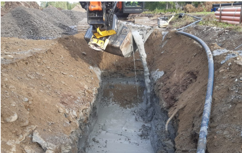
KUVA 5. Maa-ainesten löyhyys havaittiin putkikaivannon aikana.
