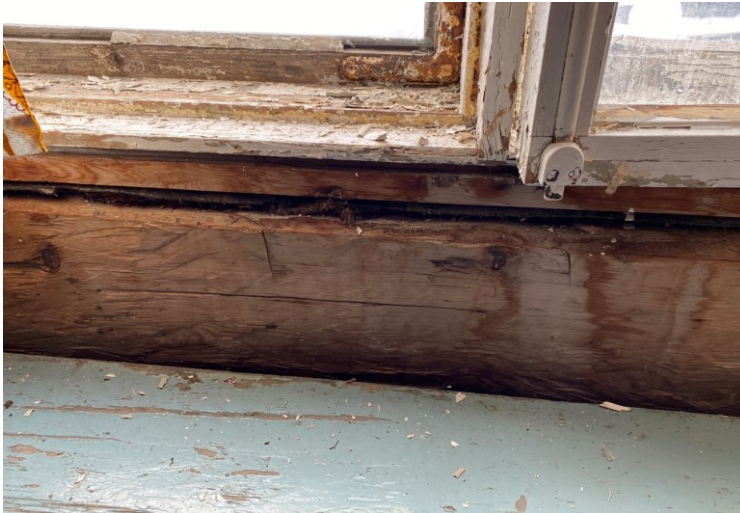
KUVA 25. Pirtin eteisenpuoleisen ikkunan vuotojälki
