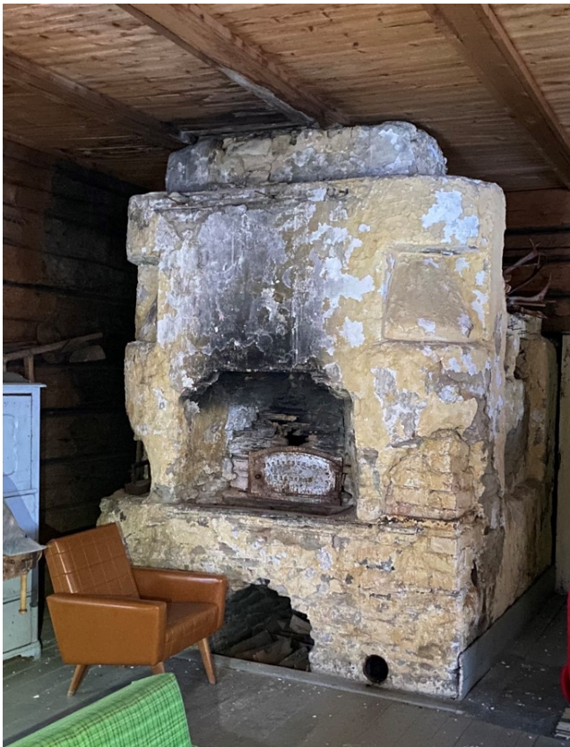
KUVA 11. Pirtin rapattu tiiliuuni
