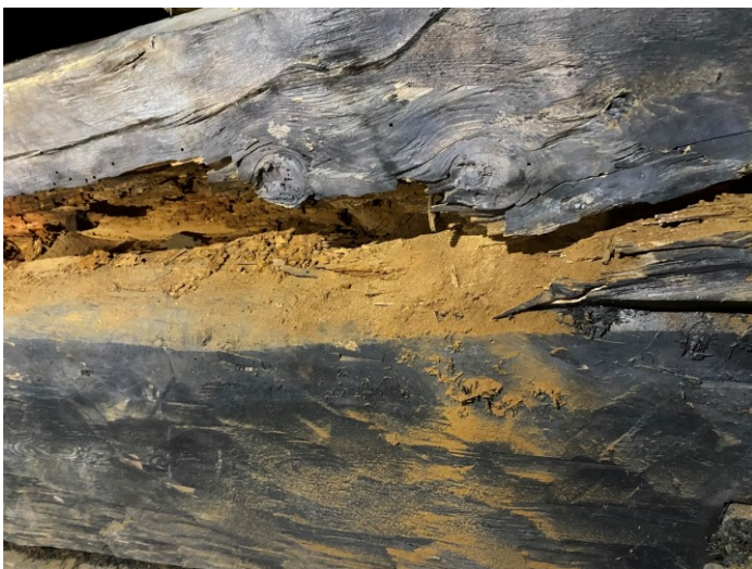
KUVA 21. Vintin keskirakenteessa lahovauriota ja tuhohyönteisten merkkejä kulkuaukon alapuolissa hirressä
