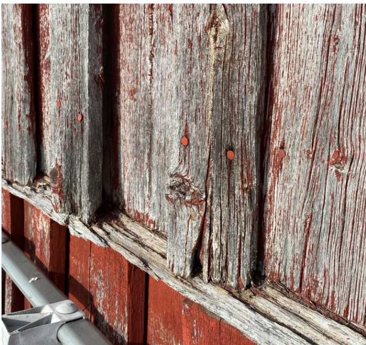
KUVA 23. Eteläseinän vaurioituneimman osan julkisivu
