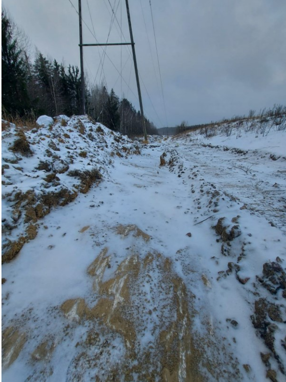
Kuva 18. Voimajohtojen alla, kaivannoissa esiin tullut kallio. Oma arkistokuva.
