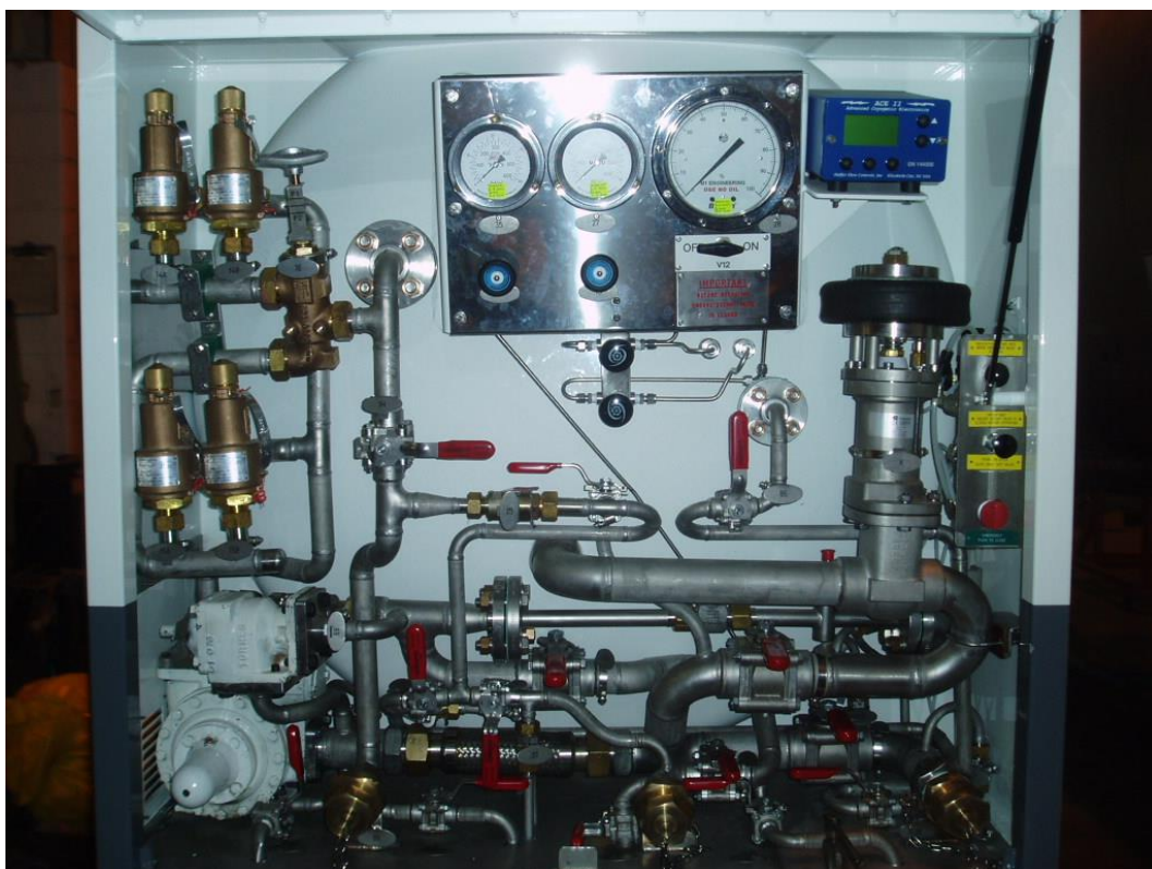
Kuva 13. Tyhjennyspumputilla varusteltu säiliö. 92
