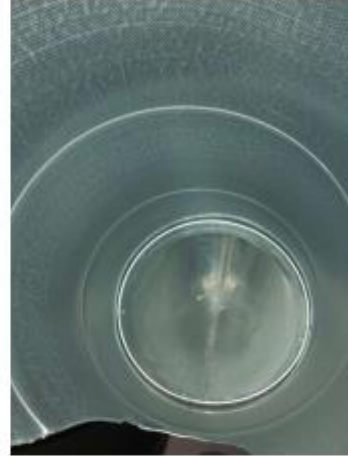
Kuva 2 Kanava puhdistusluukusta. (Kts. pohjakuvan 1, 3410308-G3-307 Ilmanvaihto Ullakko A-porras merkintä 2.)
