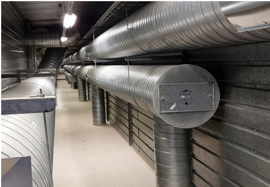
Kuva 21. Ilmanvaihto kanavien sijainti käytävällä.
