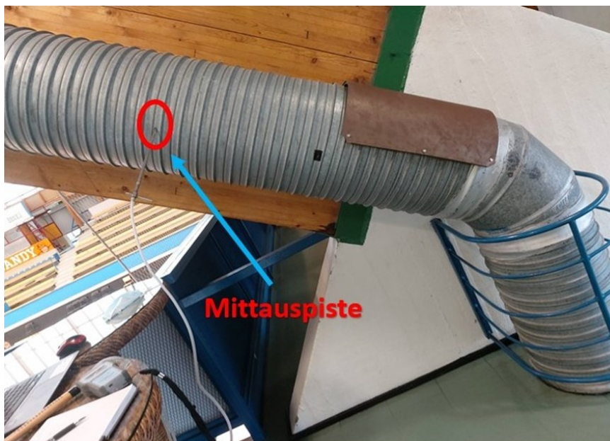
Kuva 11. Tuloilmakanavan ilmapirran mittauspiste.
