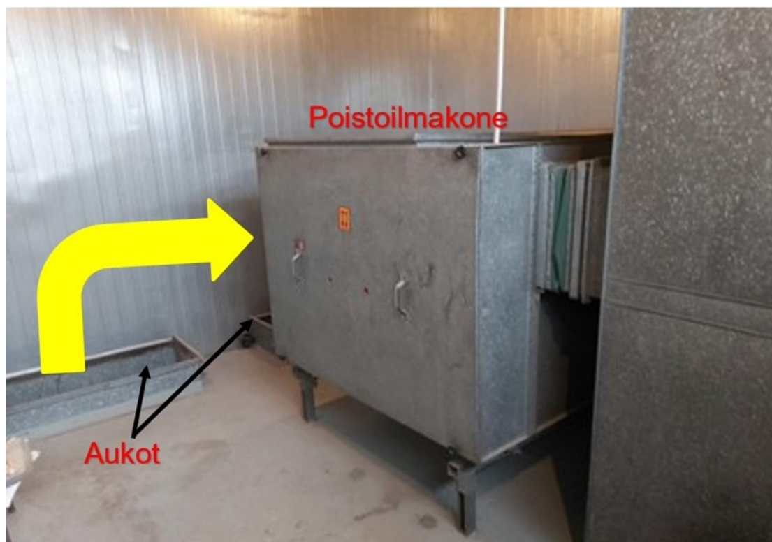
Kuva 9. Poistoilma-aukot ja -kone 8 PP.
