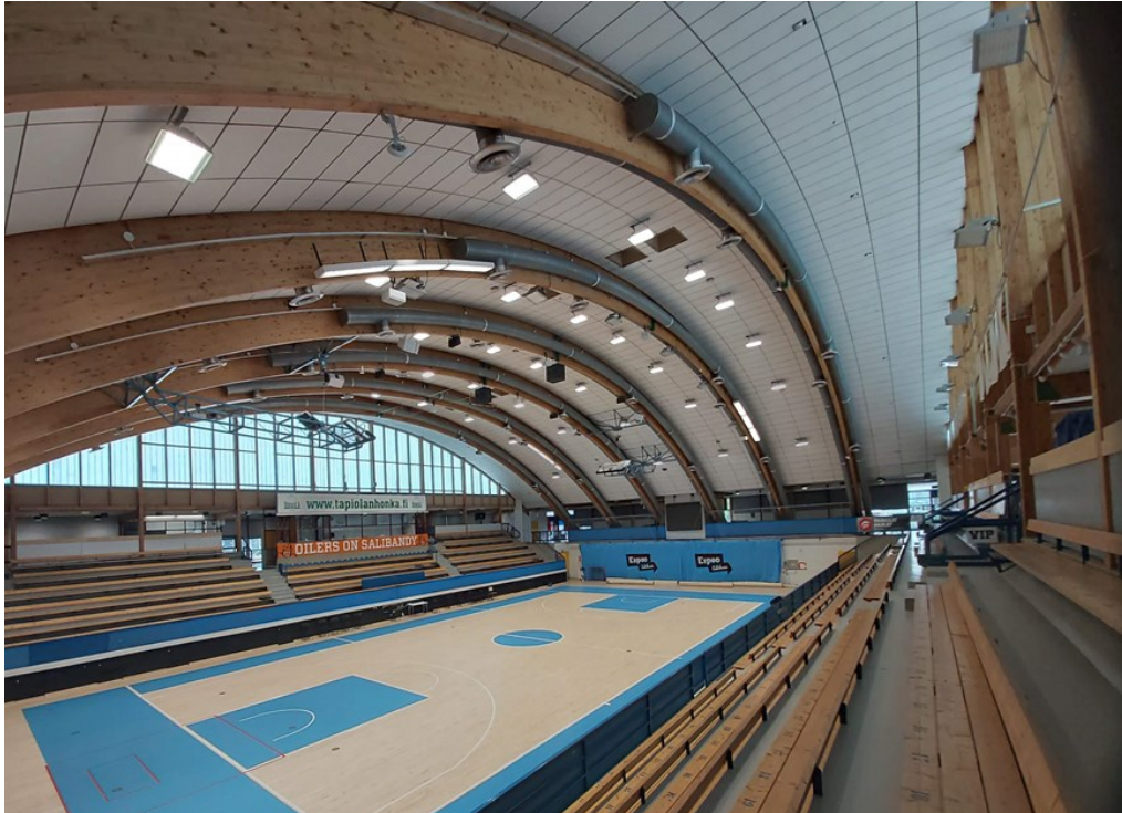
Kuva 8. Hallin tuloilmakanavat ja päätelaitteet.
