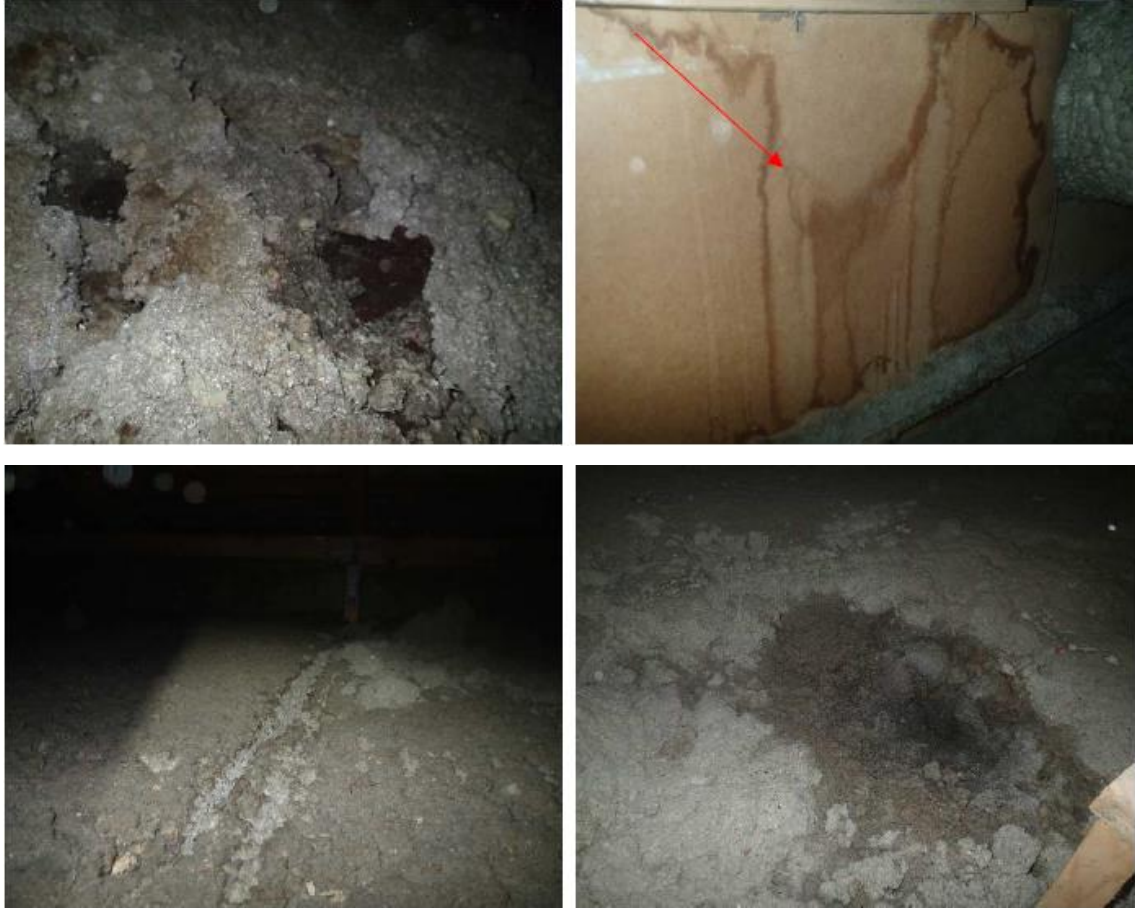
Kuva 14. Lehmon koulun vesikatevuotojen kosteus- ja mikrobivaurioita. (Kuva: Kontiolahden kunta)
