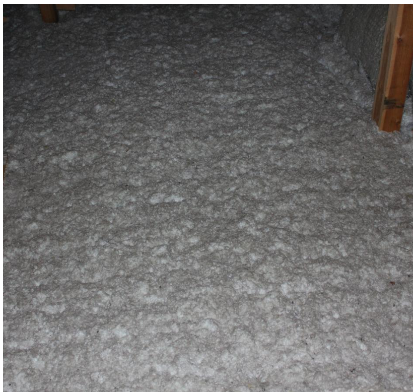
Kuva 13. Liikuntasalin yläpohjassa havaittavissa kondenssiöveden tippumisen aiheuttamia painaumuksia puhalluseristeessä.
