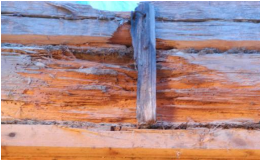
Kuvio 21. A-seinän hyönteisvauriokohta.
