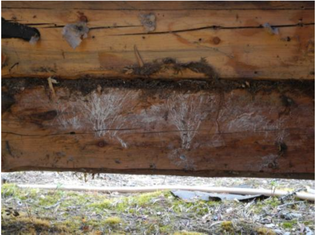
Kuvio 25. C-seinän lattiasienirihmaston jälkiä.
