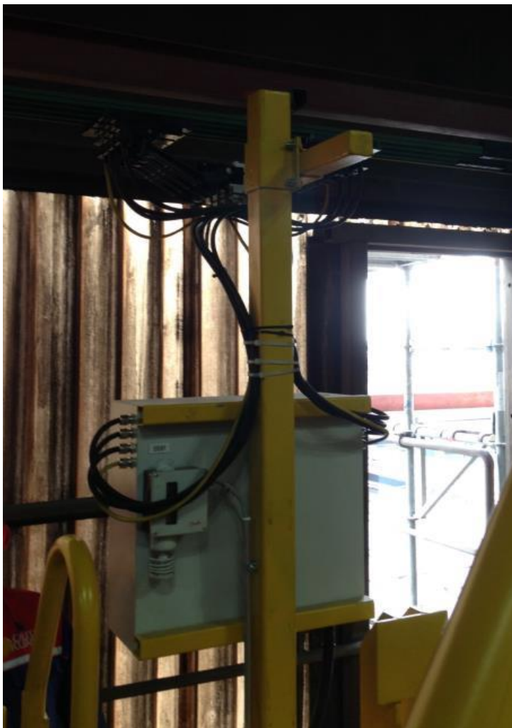
Kuva 14. Virtalinjasta tuleva sähkönsyöttö nosturille
