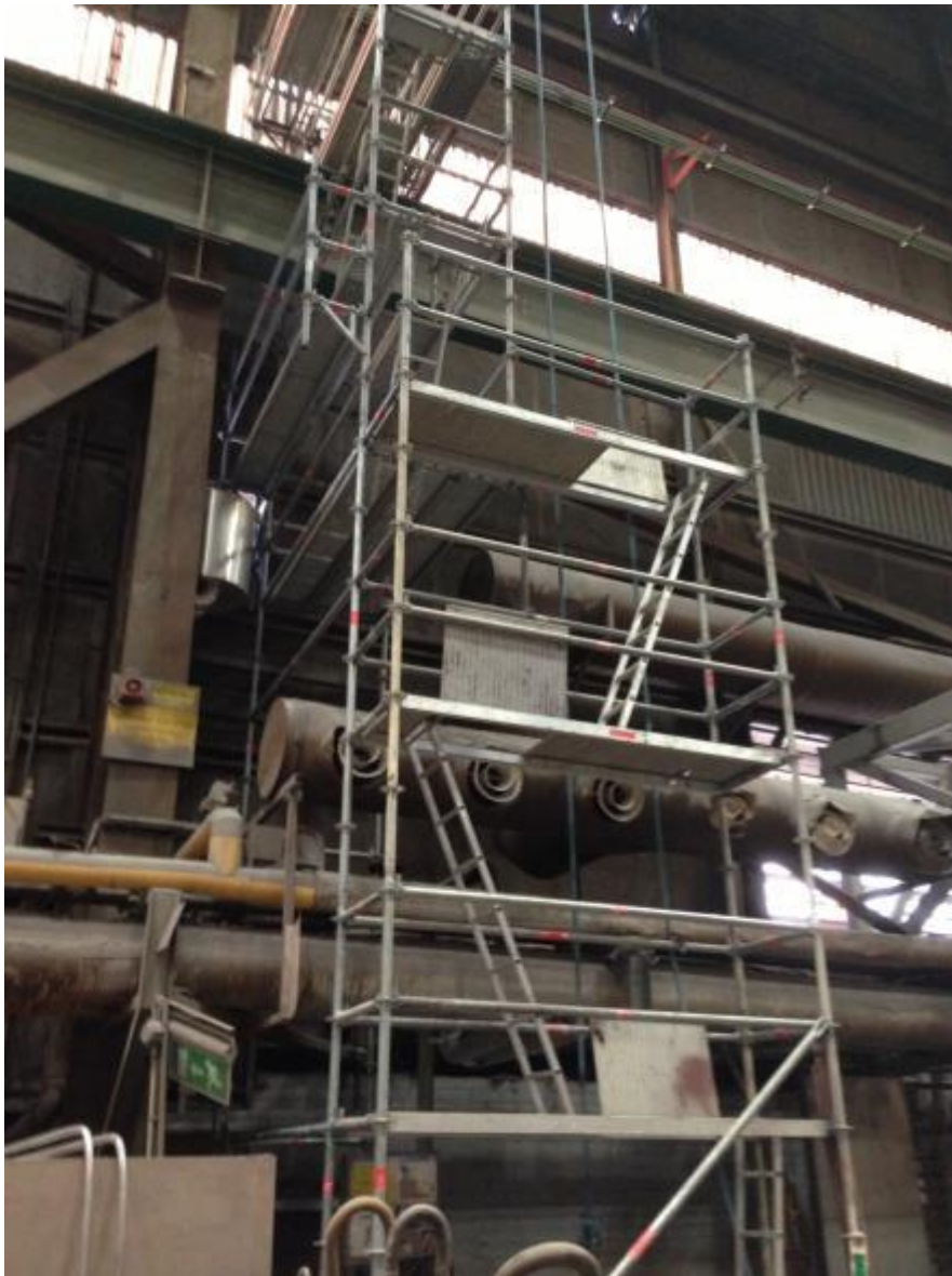
Kuva 30. Telineet sähkönsyöttöä varten
