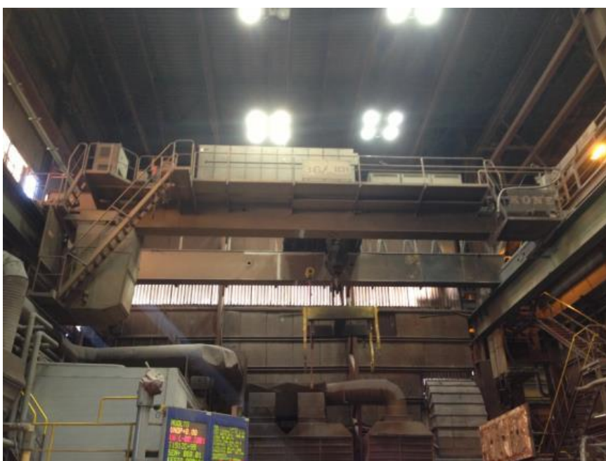
Kuva 16. Purun kohteena oleva siltanosturi
