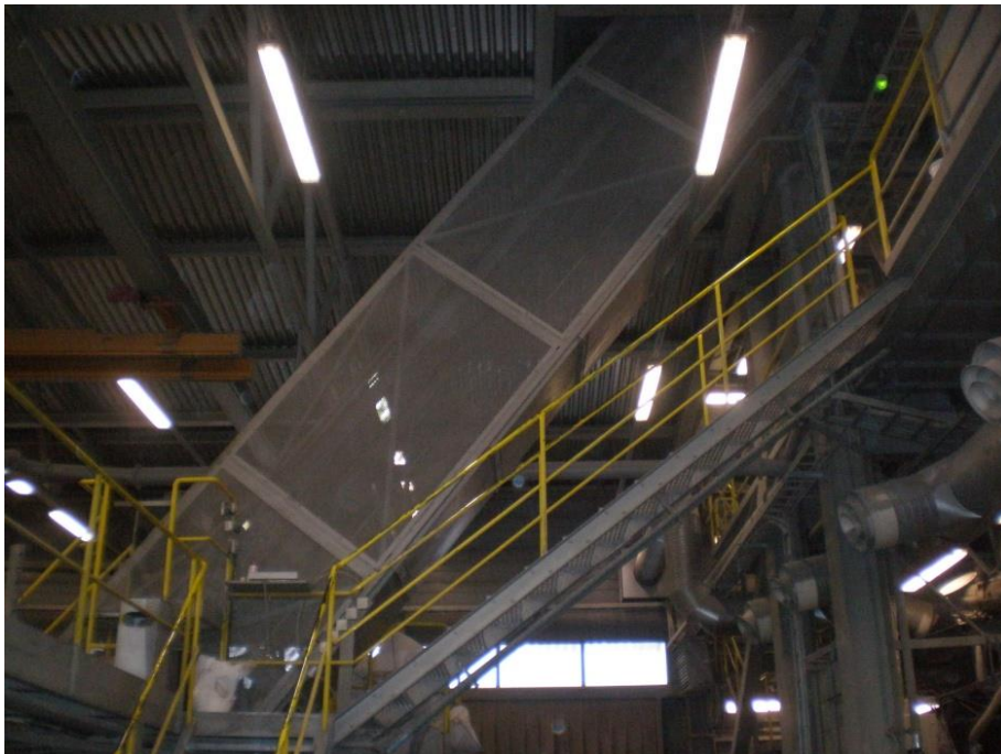
KUVIO 3. Kuilu ja vasemmassa alakulmassa taso, jolta sideainesilot täytetään.
