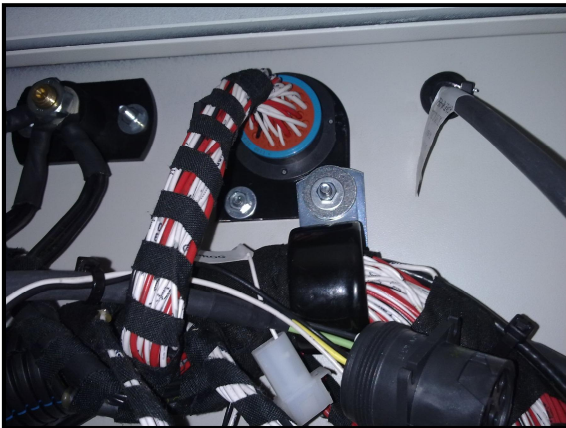
Kuva 11. Liitinten ja johtosarjojen läpiviennit. (Kuva: Jani Varis.)
