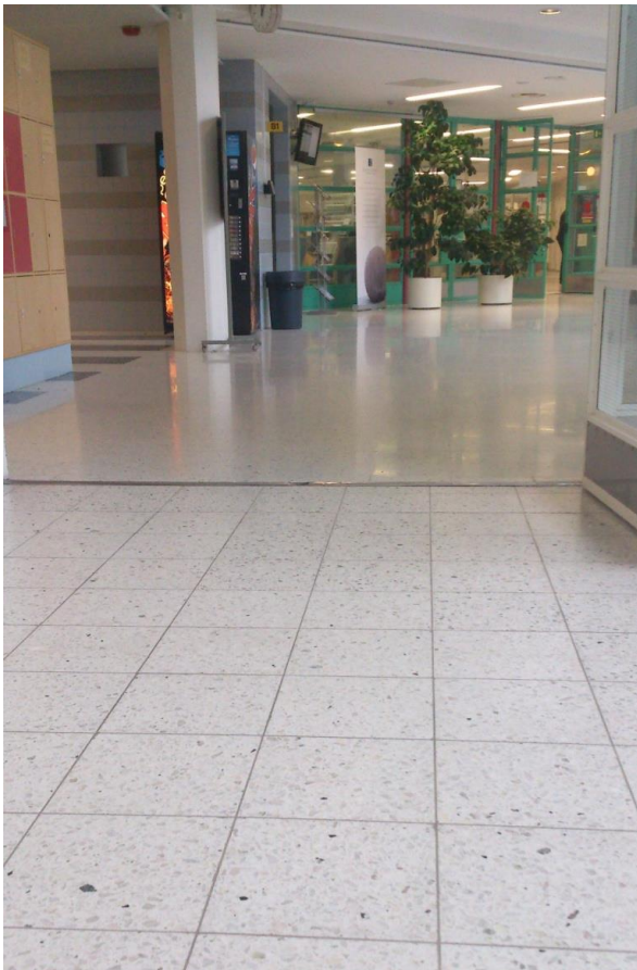
KUVA 4. Etualalla vanhaa, hiomatonta mosaiikkibetonilaattalattiaa ja taka-alalla täysin samaa materiaalia, mutta hiottu, pintakäsitelty ja vahattu 3 vuotta sitten.
