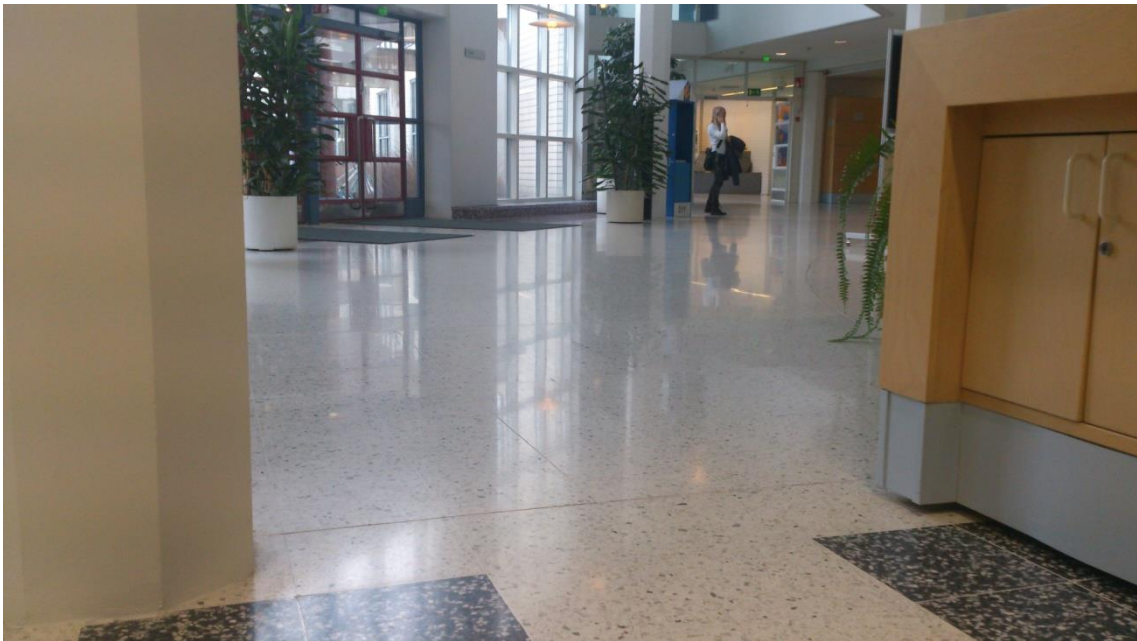
KUVA 28. Oulun yliopistolla vuonna 2011 hiottua valkoista mosaiikkibetonilattiaa.
