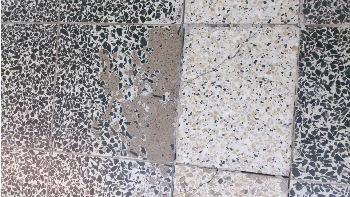
KUVA 30. Painunut tumma mosaiikkibetonilaatta, joka olisi täytynyt vaihtaa ennen hiontaa. Ongelma on aiheuttanut ulkonäköhaitan sekä vaurioita myös viereisille laatoille ja saumoille.
