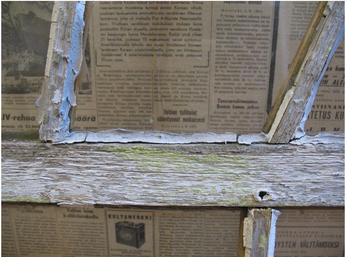
Kuva 13. Kuistin ikkuna verstaalla odottamassa kunnostusta.
