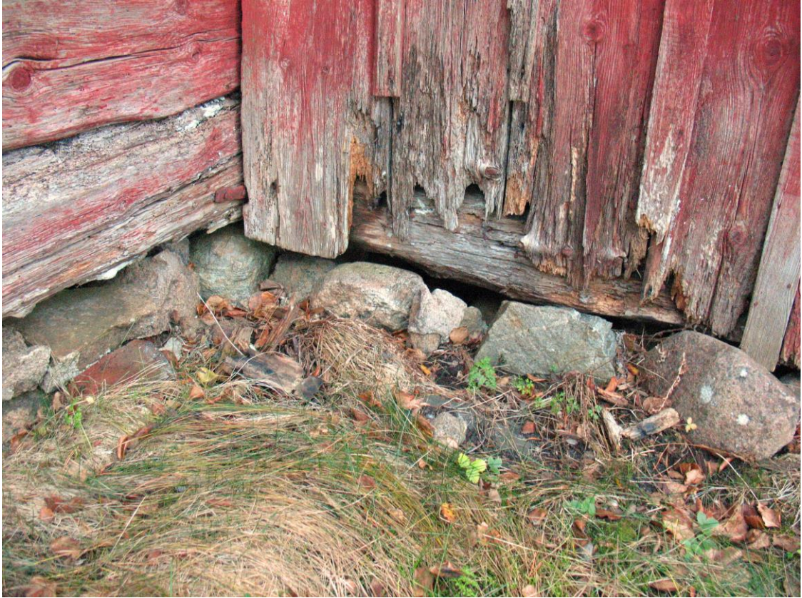
Kuva 17. Kuistin lattiankannattimet lepäävät olemattoman kivijalan varassa.
