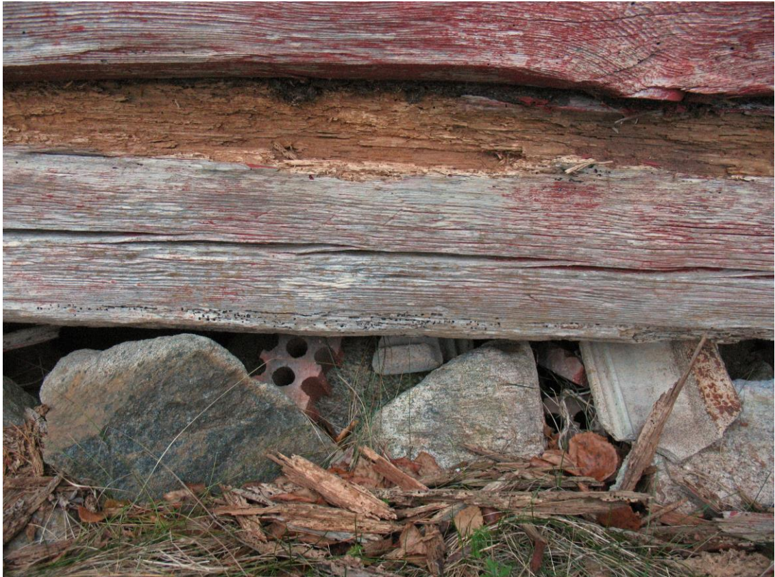
Kuva 16. Ruskolahon ja hyönteisten vaurioittama alahirsi pohjoisseinällä.
