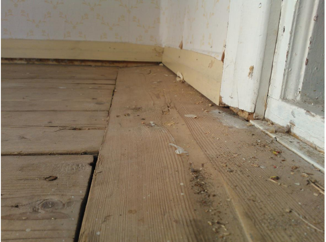
Kuva 22. Pohjoiskamarin lattialankut ovat painuneet.
