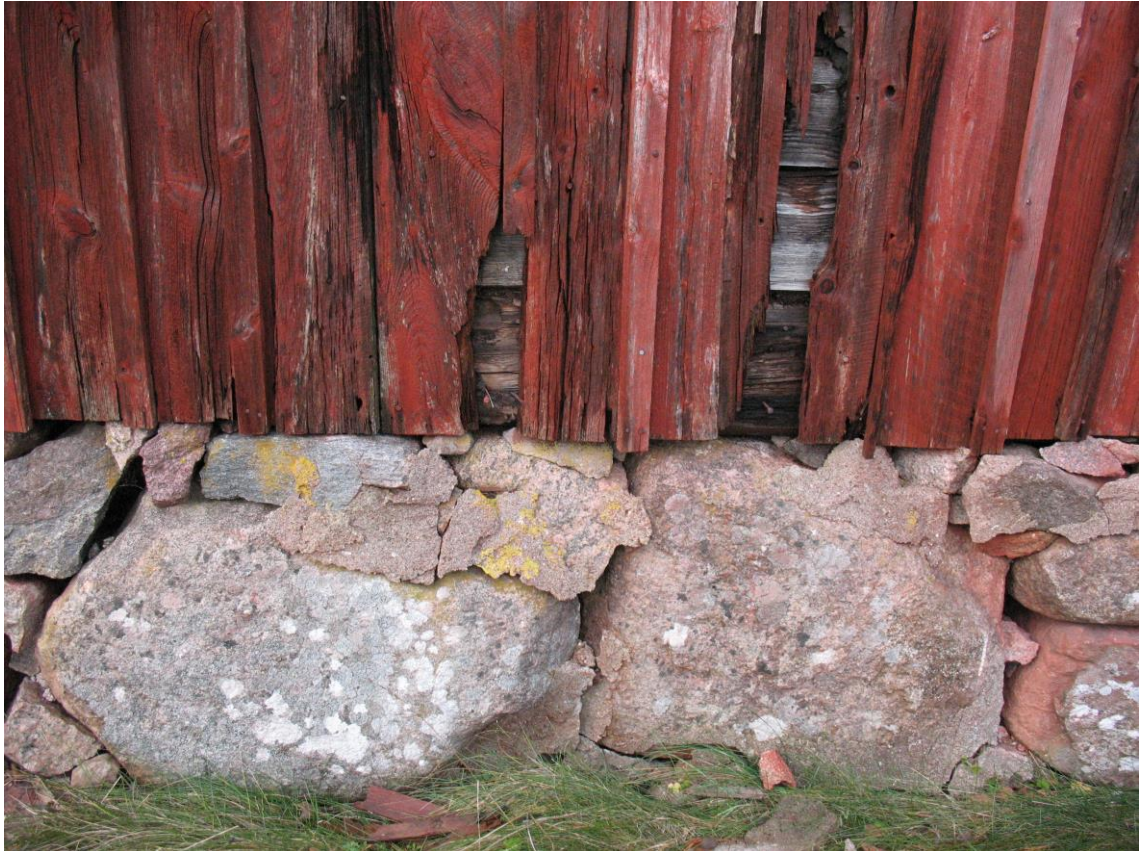
Kuva 20. Kivijalan lohkeillutta sementtisaumausta eteläseinällä.
