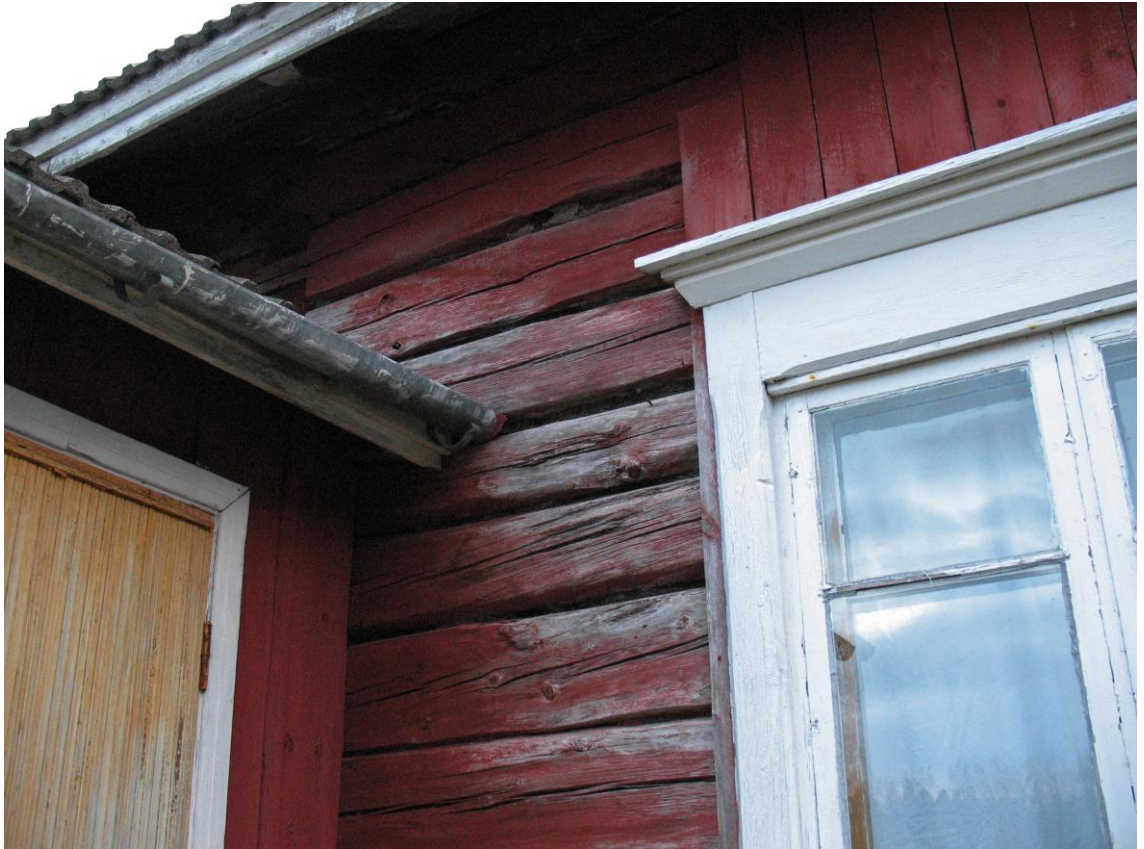
Kuva 8. Sadeveden huuhtomaa hirsirunkoa pohjoisseinällä.
