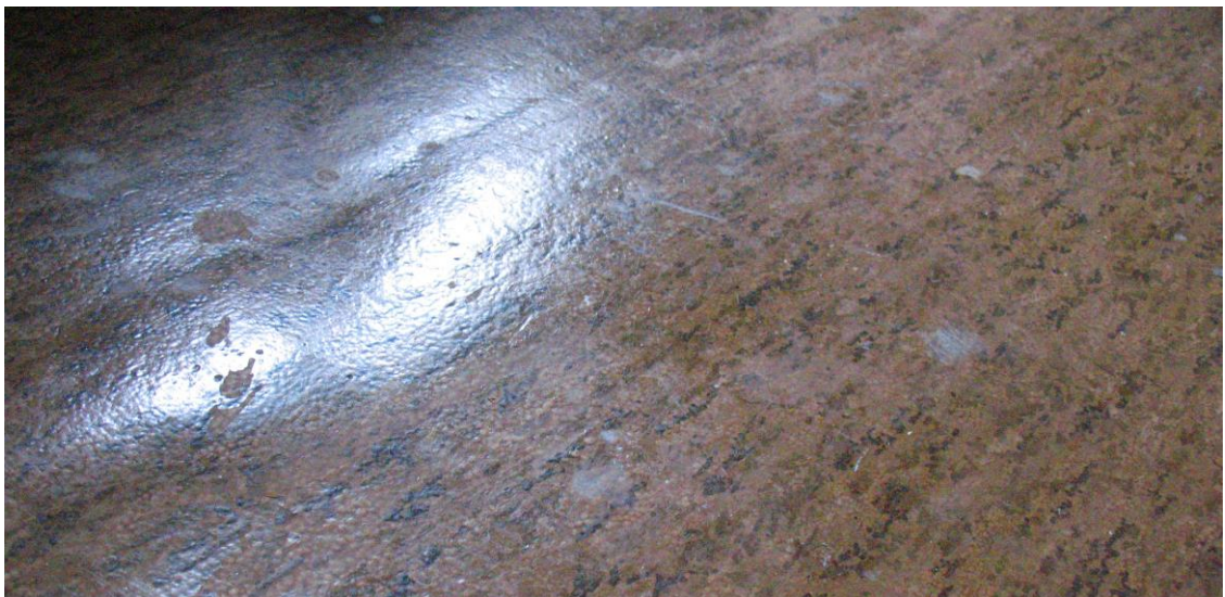
Kuva 24. Eteläkamarin linoleummaton läpi tuntuu lattialaudoituksen polveilu.
