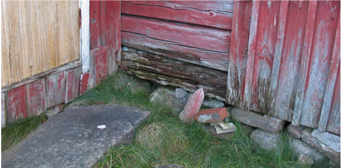
Kuva 19. Alapohja tuulettuu puutteellisesti pohjoisseinällä.
