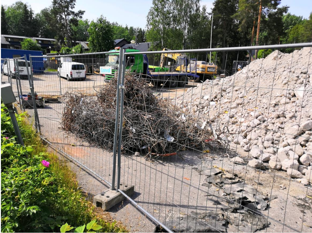
Kuva 9. Pulveroitua betonia, josta on erotettu raudat.
