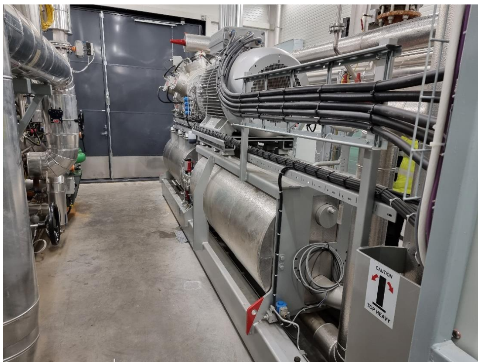
Kuva 16, Toinen lämpöpumpuista (Vuorio, 7.12.2021)
