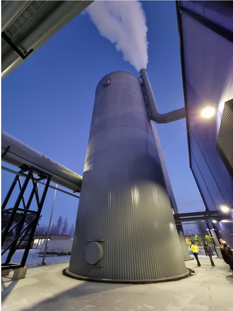
Kuva 18, Voimalaitoksen pihalla olevat kaukolämpöakut (Vuorio, 7.12.2021)
