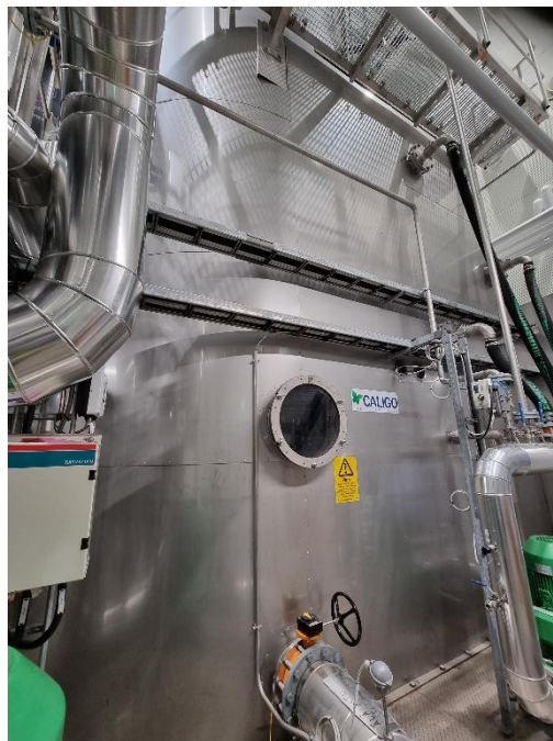
Kuva 14, Hönkäkaasujen pesuri (Vuorio, 7.12.2021)
