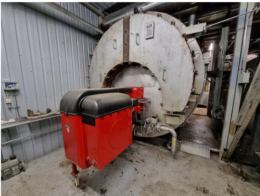
Kuva 19, 8 MW nestekaasukattila (Vuorio, 7.12.2021)
