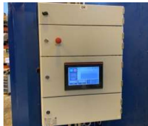
Kuivausuunin uusi ohjauskeskus
